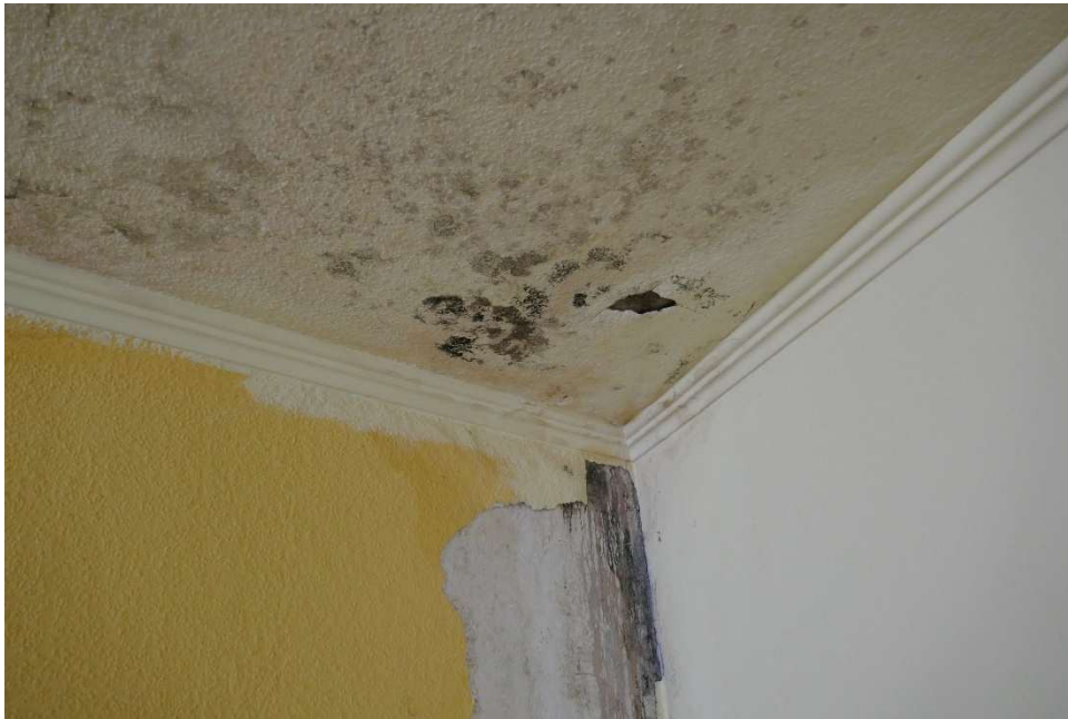
Bild 13: Feuchtigkeitsschäden im 1. Obergeschoss des Anbaus
