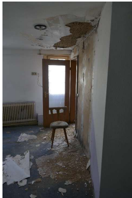
Bild 12: Wasserschaden im 1. Obergeschoss des Anbaus
