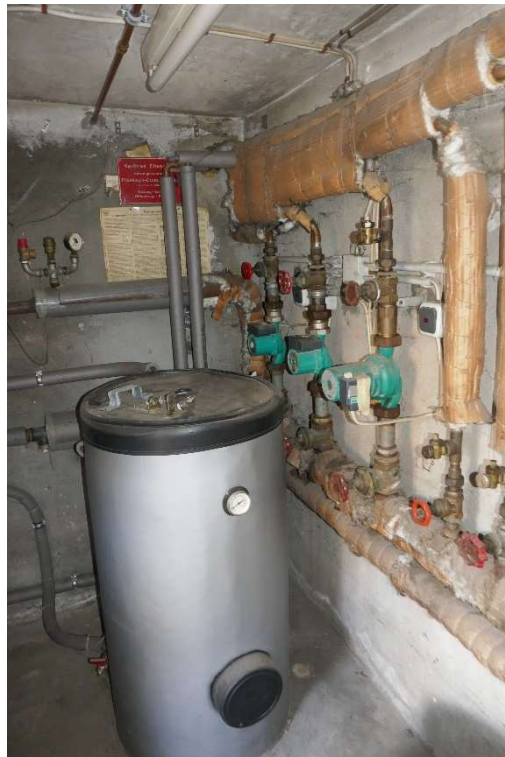
Bild 20: Haustechnik im Kellerbereich des Anbaus
