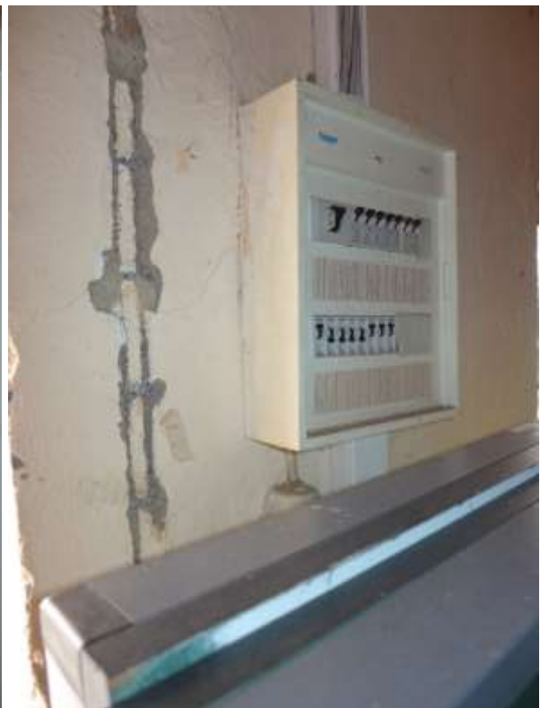
22 b Elektroverteilung Nebengebäude
