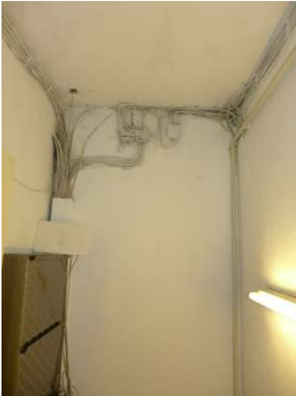
21 a Elektrokabel im Kellerabgang
