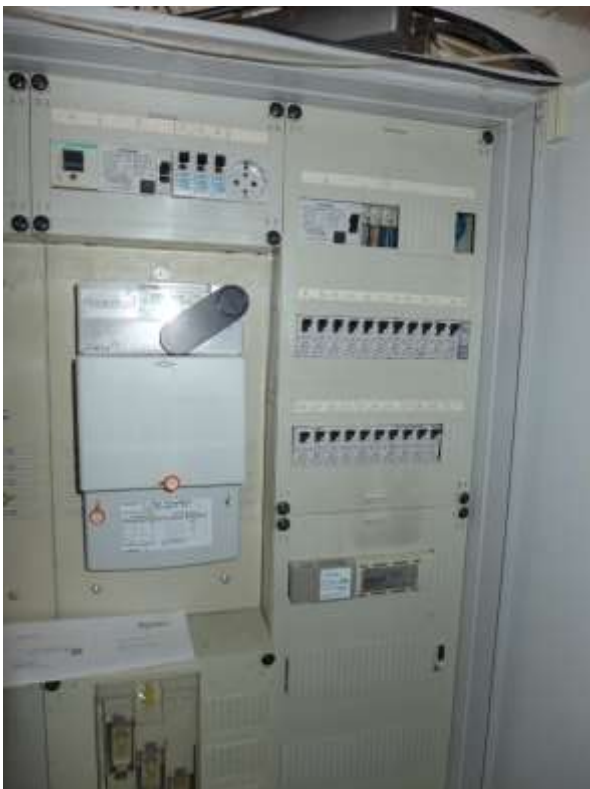
22 a Elektroverteilung Wohnhaus
