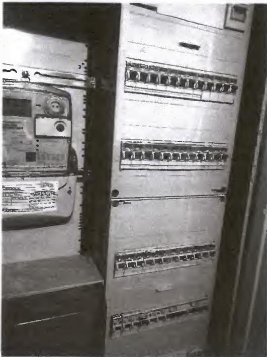
Zählerschrank mit Unterverteilung
