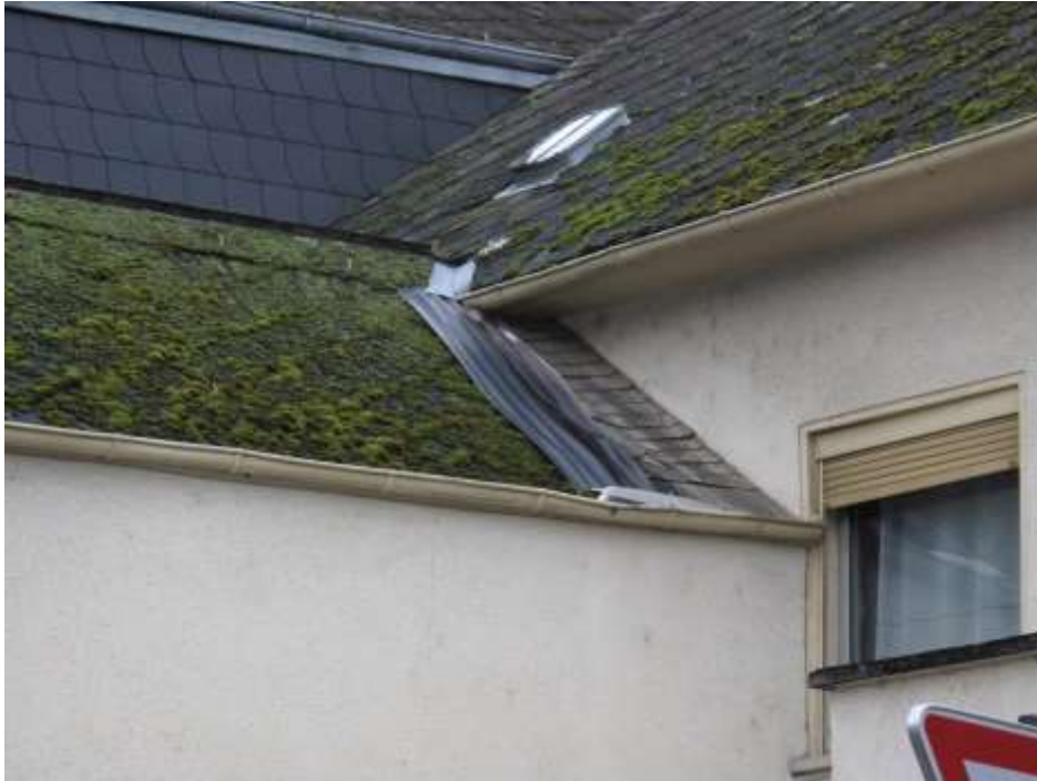
Foto Nr. 09: Detail Schaden am Dach
