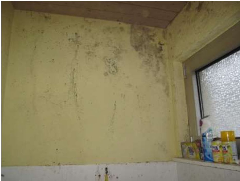
Foto Nr. 19: EG, WC mit Schimmel
