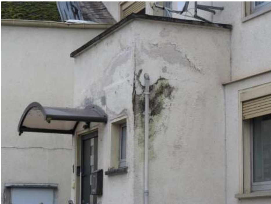
Foto Nr. 10: Detail Feuchtigkeitsschaden Balkon
