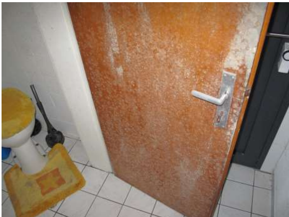
Foto Nr. 20: EG, WC mit Schimmel
