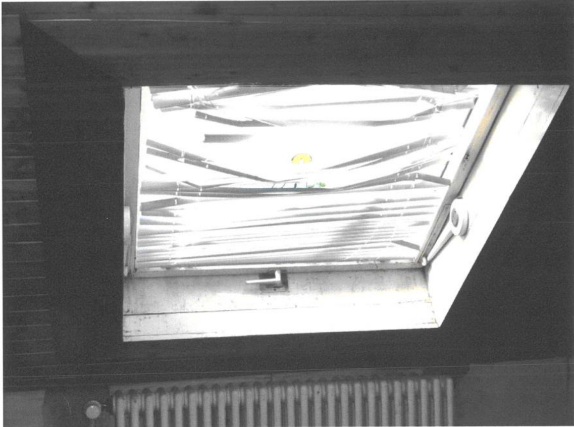
Defektes Dachfenster, Camberger Straße 51, Hünfelden-Ohren
