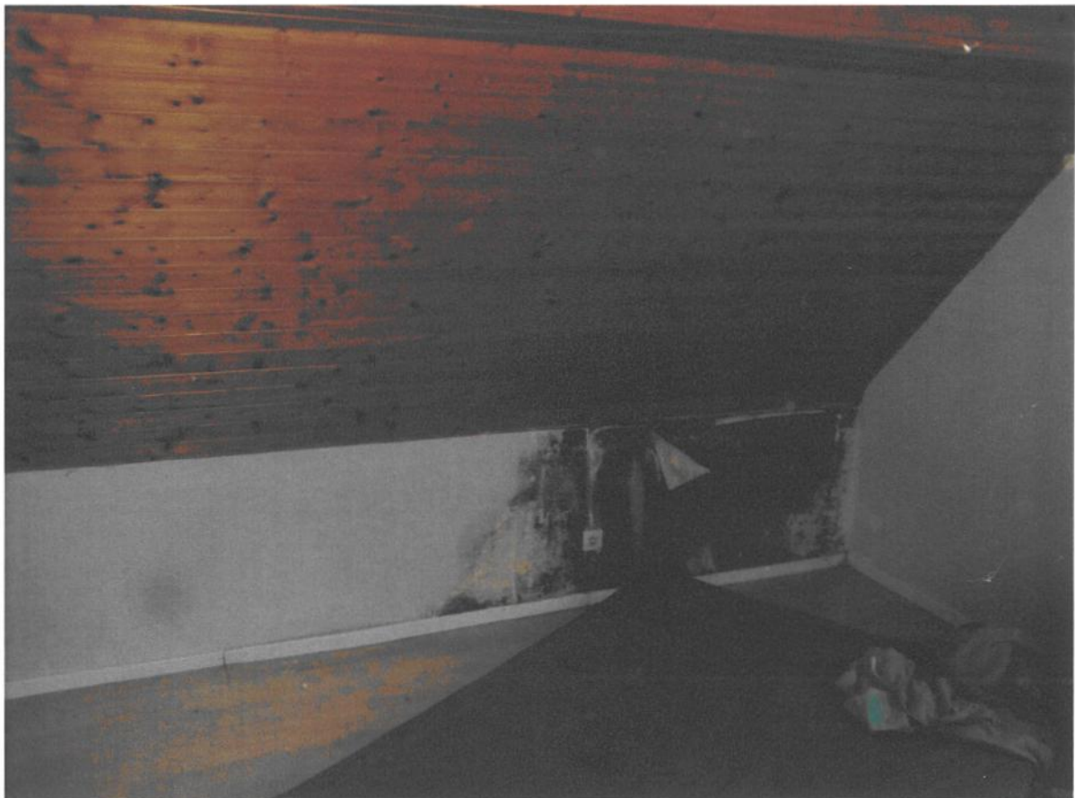
Schimmelbildung im Dachgeschoss, Camberger Straße 51, Hüfelden-Ohren
