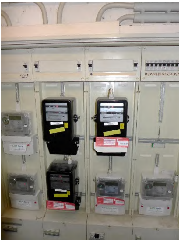
18 a erneuerte Elektrohauptverteilung
