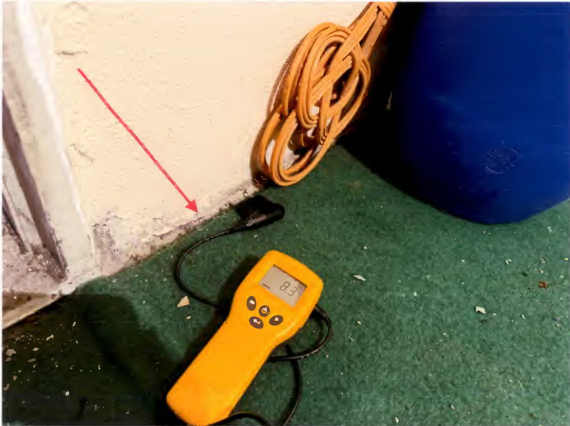
Foto 15 - Aufsteigende Feuchtigkeit ehem. Öllager
