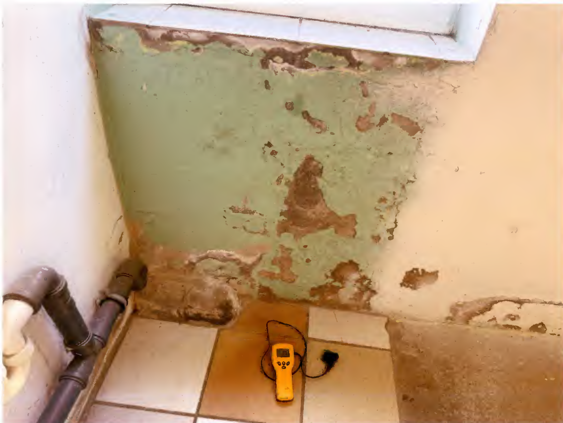
Foto 13 - Feuchtigkeit westliche Außenwand mit Salpeterausblühungen
