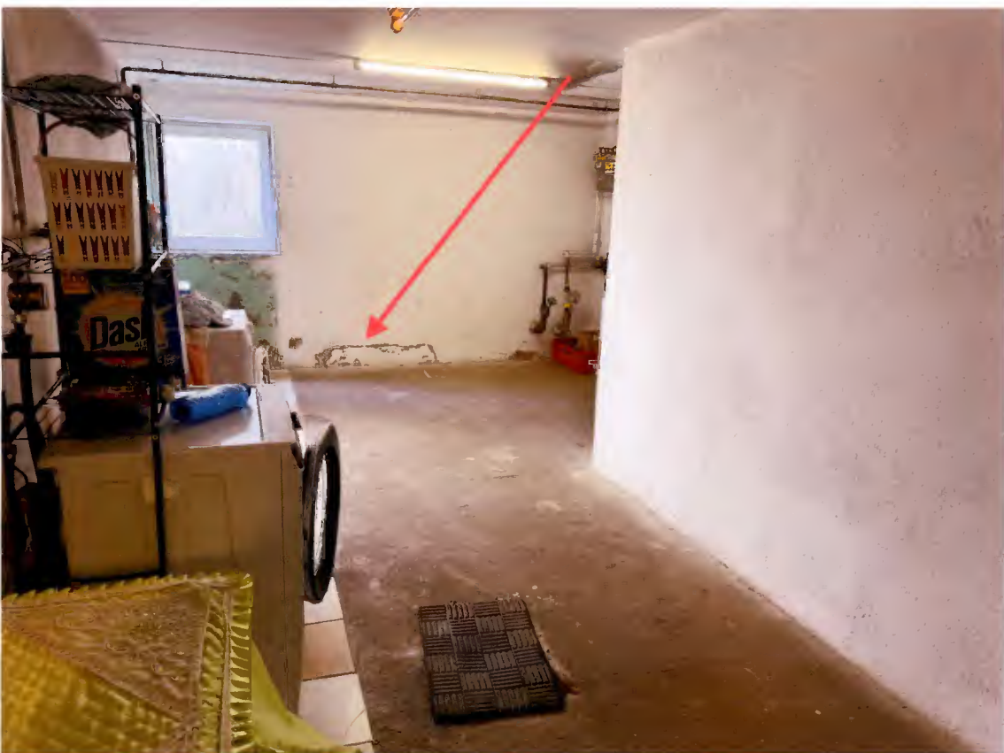
Foto 12 - Waschküche KG / durchdringende Feuchtigkeit westliche Außenwand
