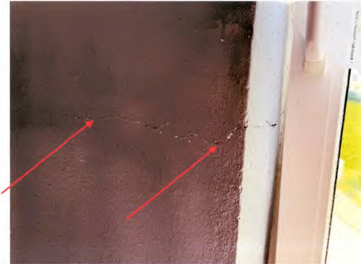
Foto 25 - Horizontalriss südliche Außenwand auf Höhe des Zwischenpodestes
