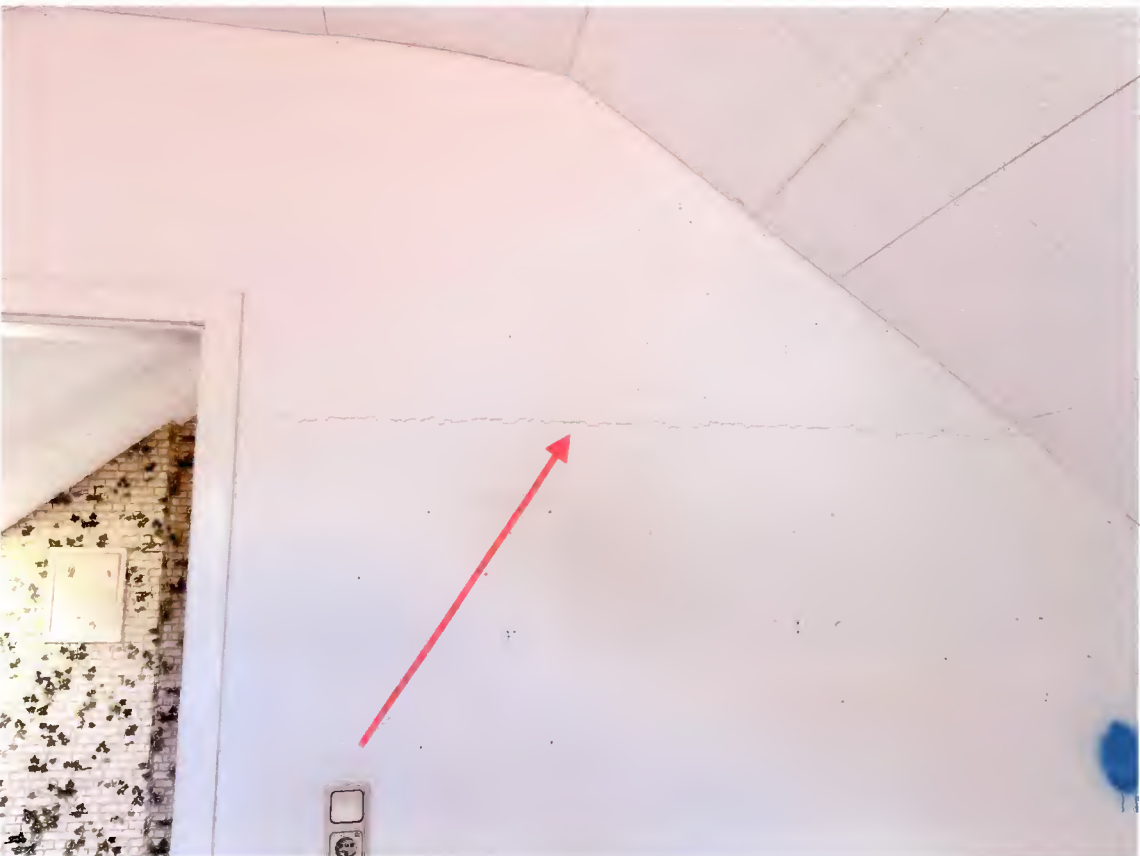
Foto 28 - Horizontalriss Trennwand Spitzbogen
