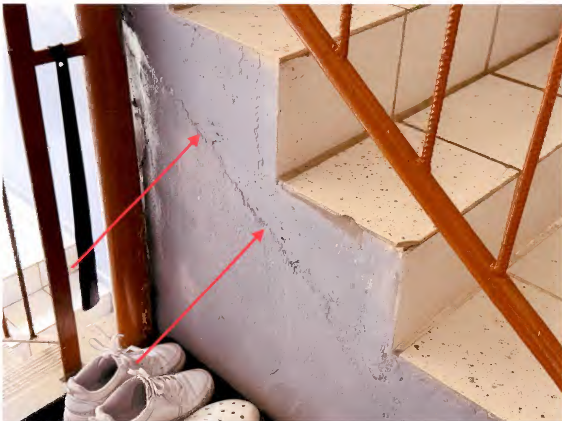
Foto 32 - Rissbildung Stahlbetontreppe zum Spitzboden
