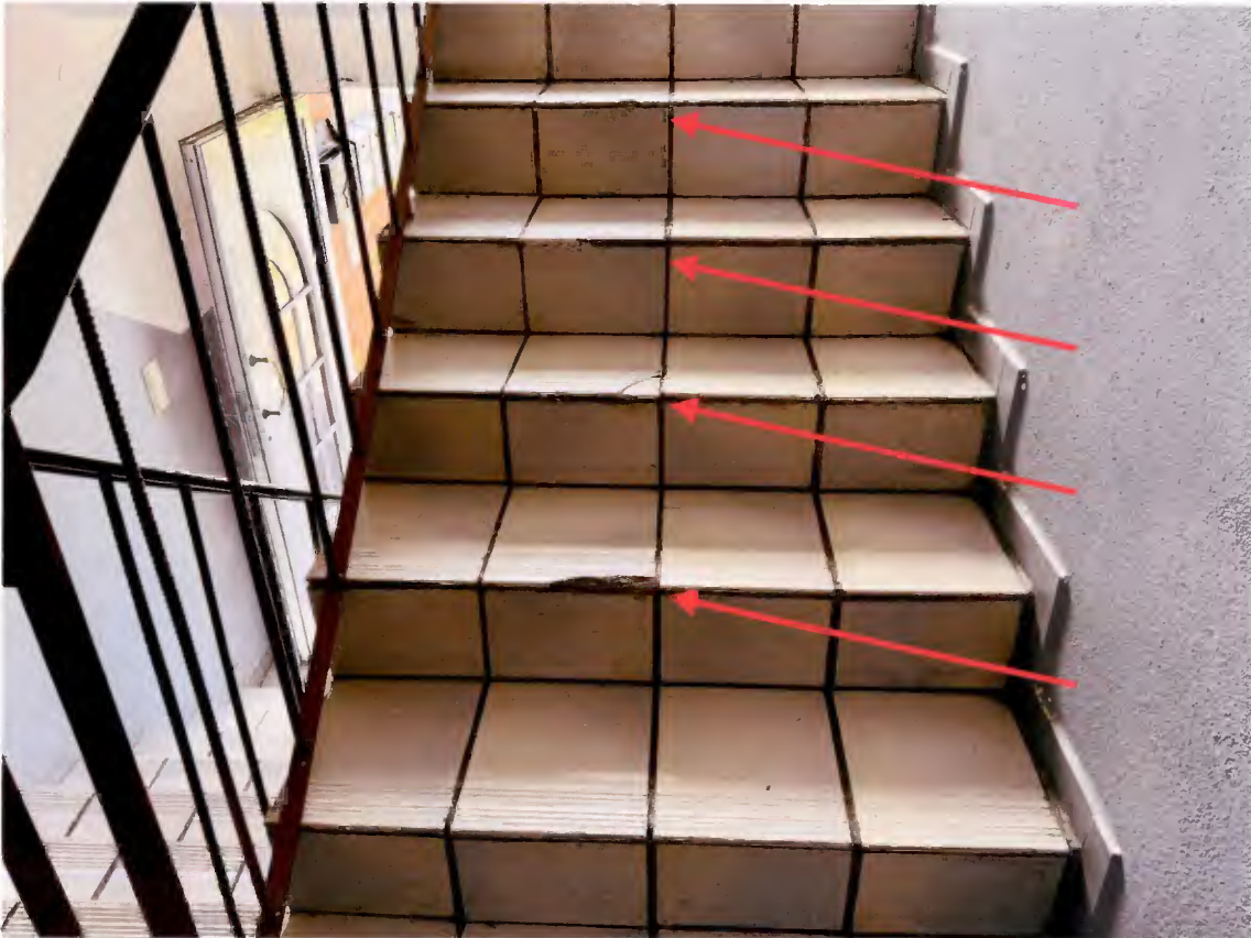
Foto 21 - Sanierungsbedarf Treppe EG zum Zwischenpodest 1. OG
