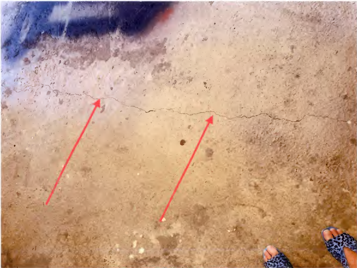
Foto 19 - Rissbildung Bodenplatte Waschküche
