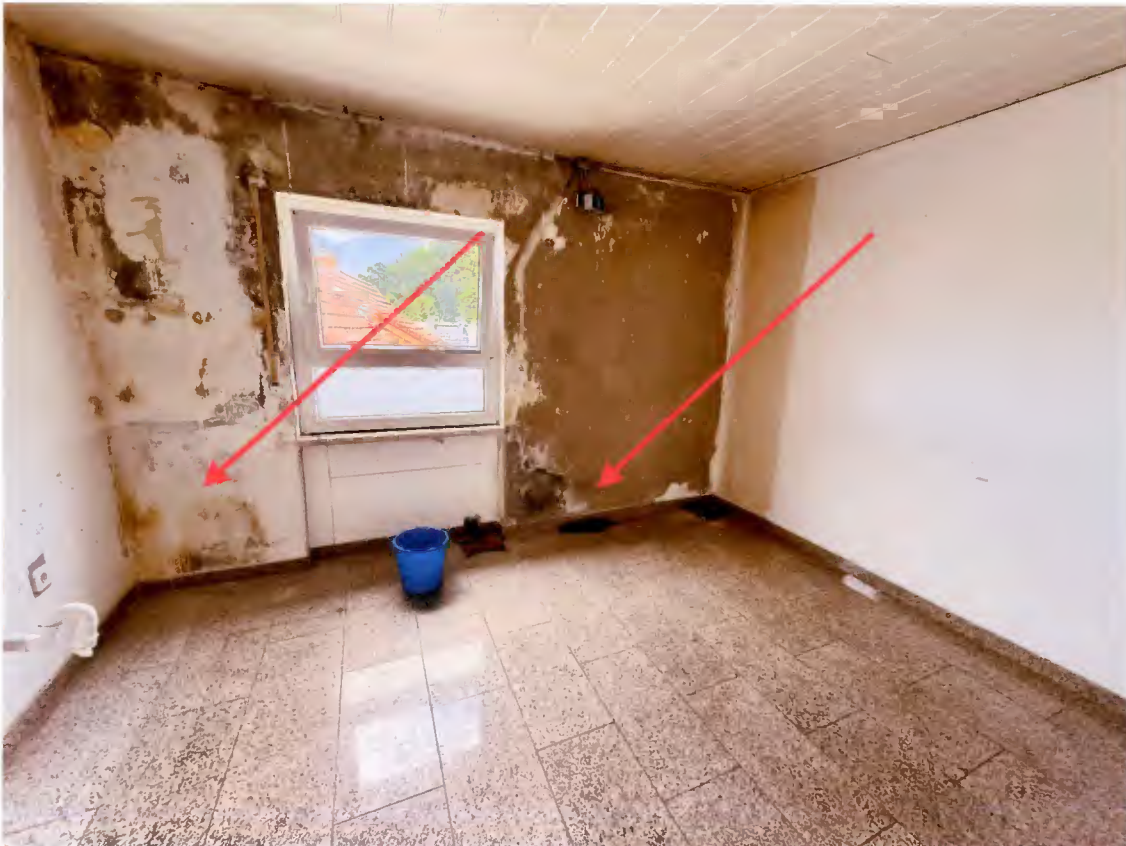
Foto 29 - Küche DG Wohnung links / Feuchtigkeit westliche Außenwand
