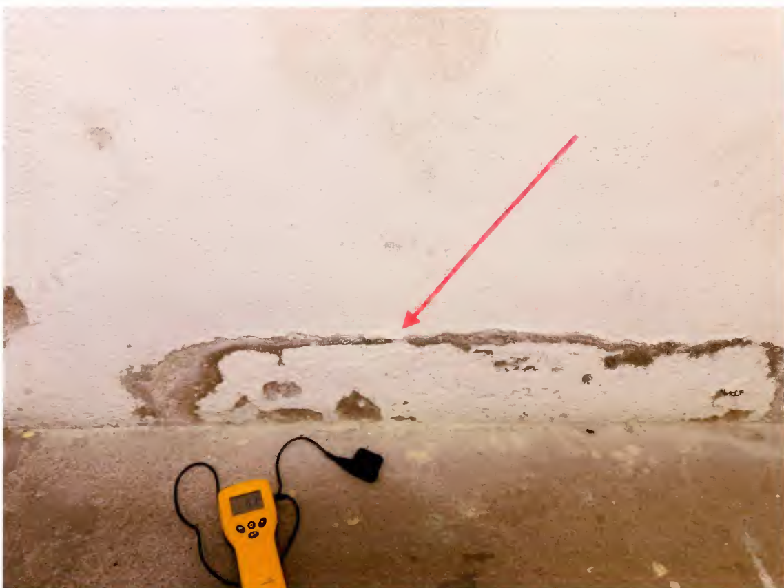
Foto 14 - Feuchtigkeit westliche Außenwand mit Salpeterausblühungen
