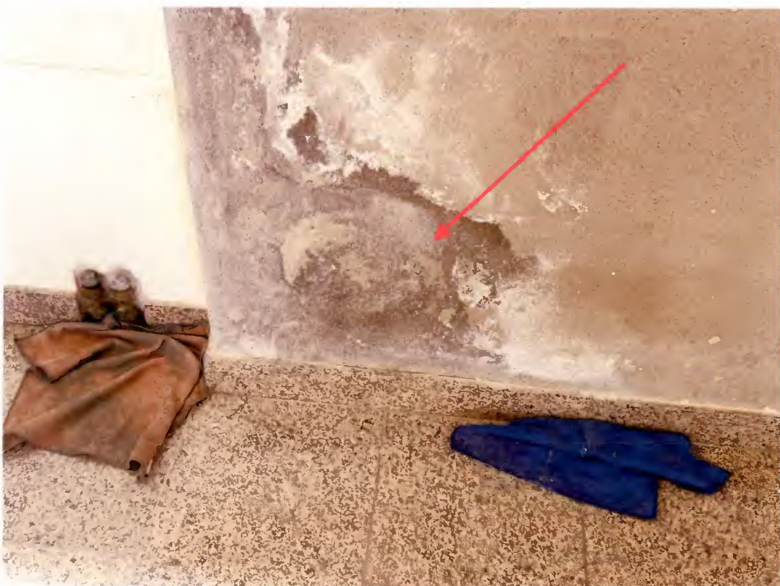
Foto 30 - Feuchtigkeitsschäden mit Salpeterausblühungen Küche DG
