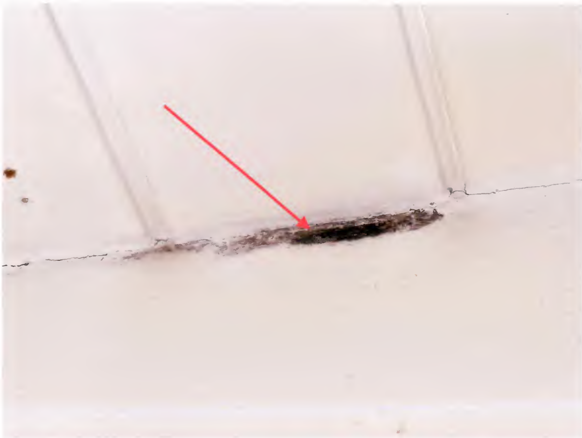
Foto 31 - Schimmelpilzbildung Kinderzimmer DG
