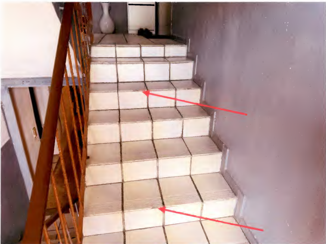
Foto 20 - Sanierungsbedarf Treppe zum EG
