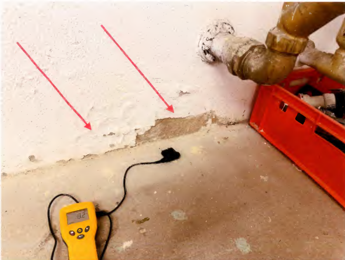
Foto 17 - Feuchtigkeit westliche Außenwand mit Salpeterausblühungen Waschküche
