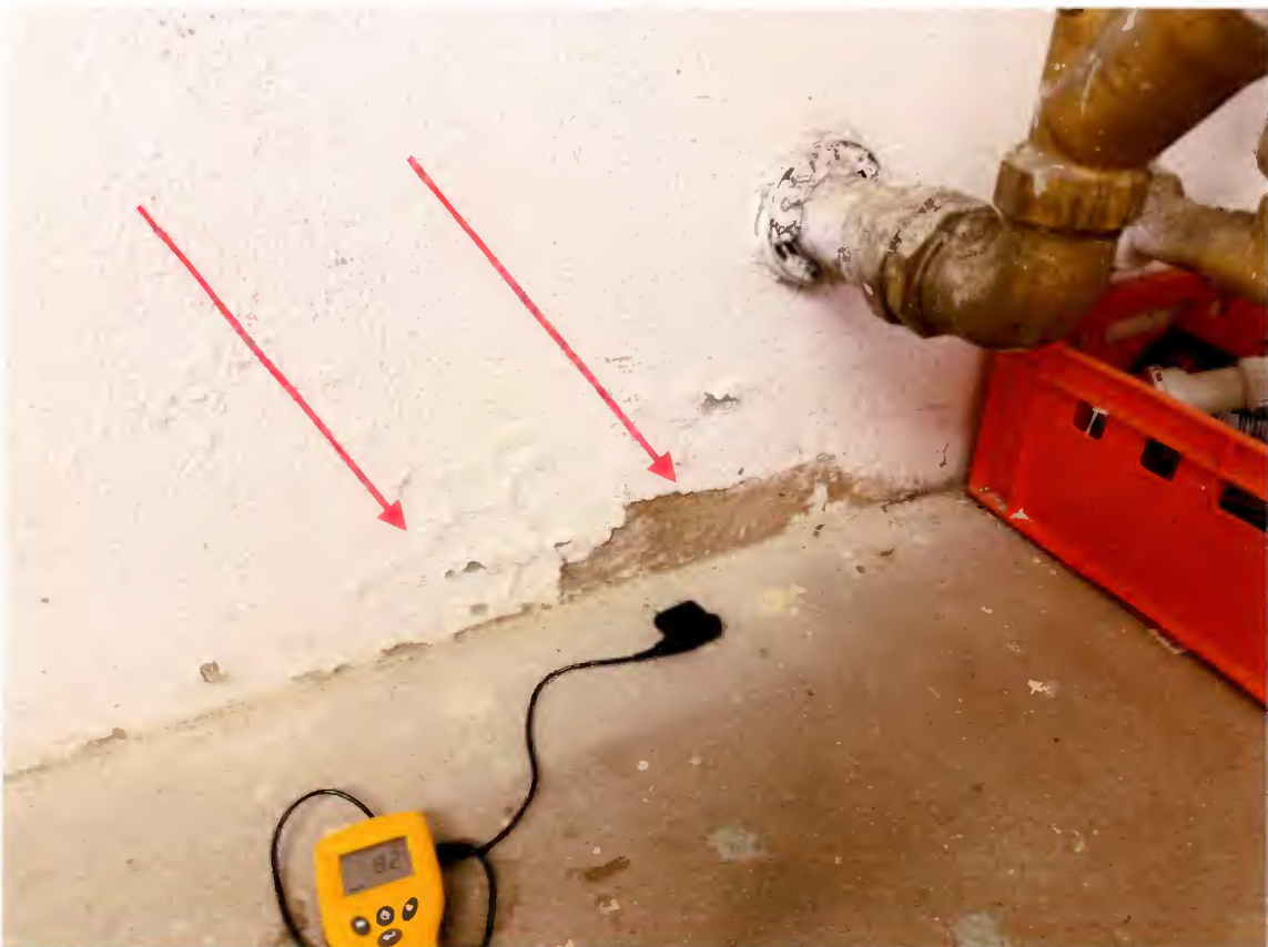
Foto 16 - Feuchtigkeit westliche Außenwand mit Salpeterausblühungen
