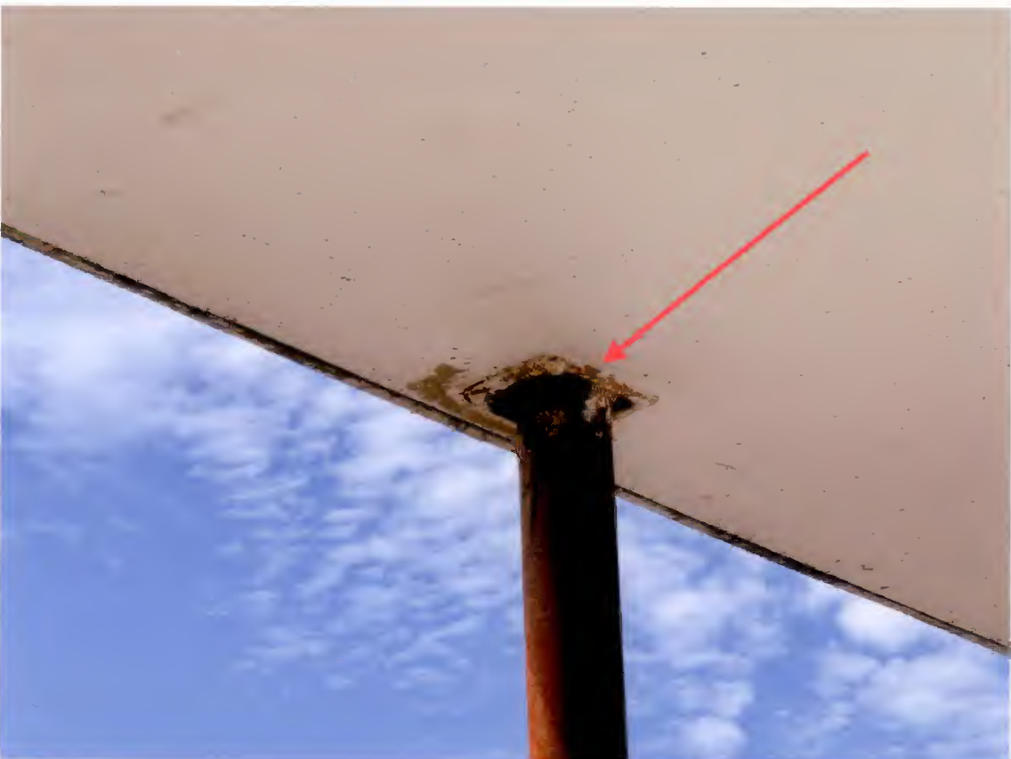
Foto 22 - Korrosion Kopfplatte Stahlstütze der Stahlbeton-Kragplatte EG Wohnung links
