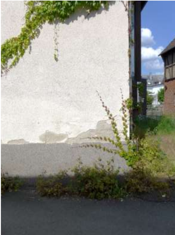
11 a Fassade Schäden
