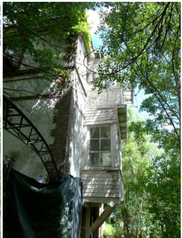
12 b Erkeranbau aus Holz Südostseite Notabdichtung links erkennbar
