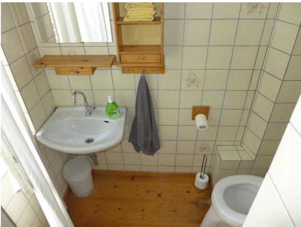
28 WC im Treppenhaus (Foto 2019)
