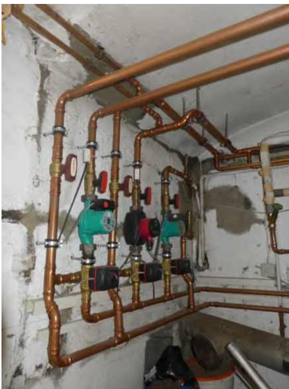
32 a Heizleitungen (Foto 2019)
