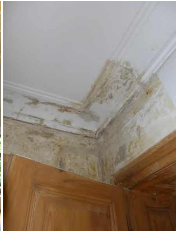
27 b Wasserschaden Treppenhaus (2019)
