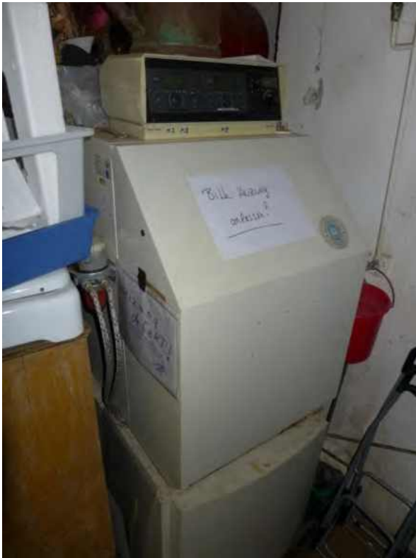
31 a Heizung (Foto 2019)
