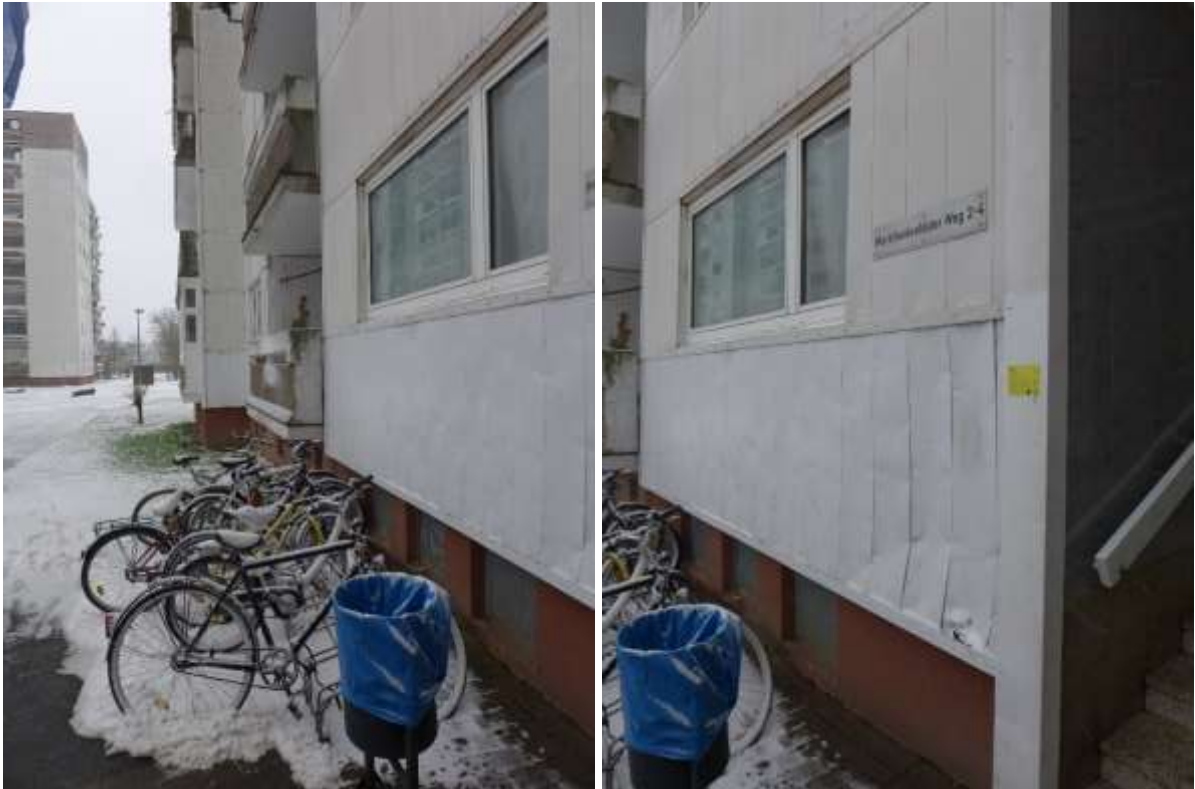
7 Fahrradständer, Zustand Fassade
