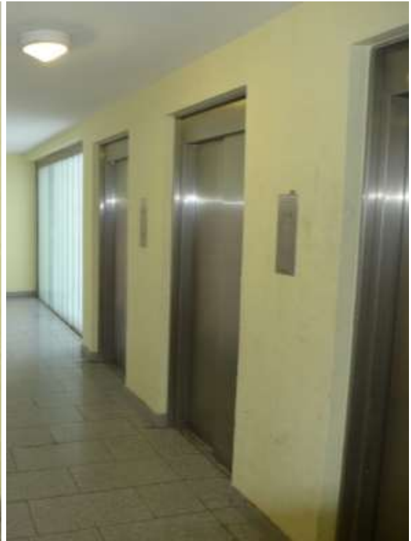
11 b Aufzugsanlage 15. OG
