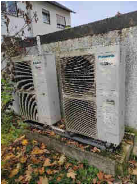
Bild 11: Heizungsanlage (Wärmepumpe) im Außenbereich
