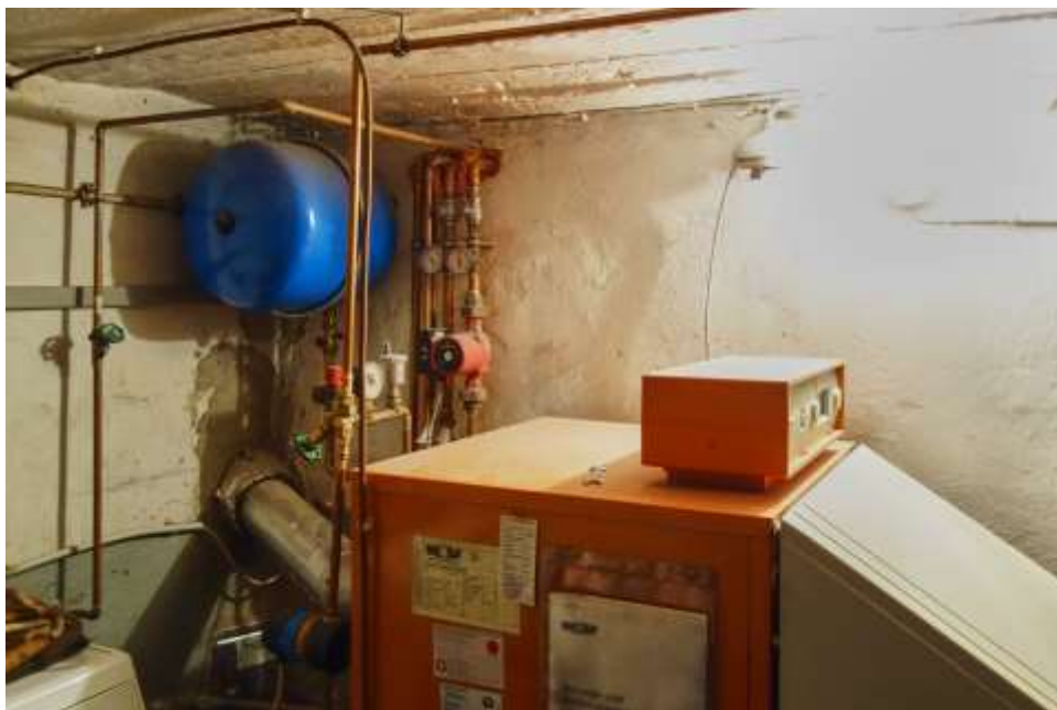
Bild 14: Ansicht Ölheizung (KG, Bj. 1996)
