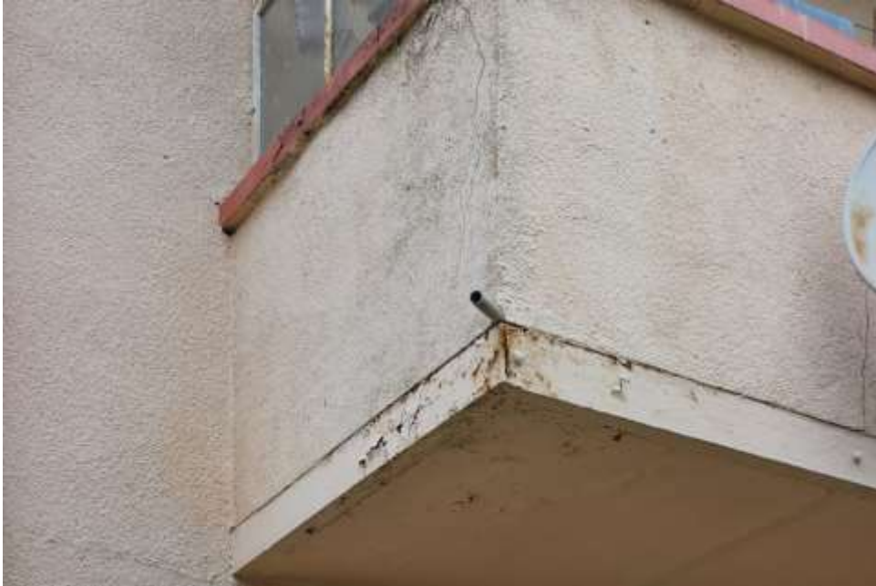
Bild 11: Ansicht Balkon (Untrhaltungsrückstau)
