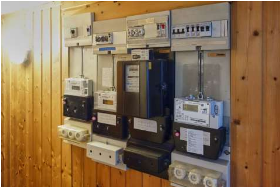
Bild 12: Ansicht Hausanschluss Elektro (KG)
