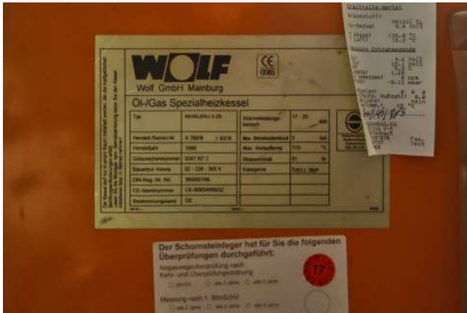
Bild 13: Ansicht Ölheizung (KG, Bj. 1996)
