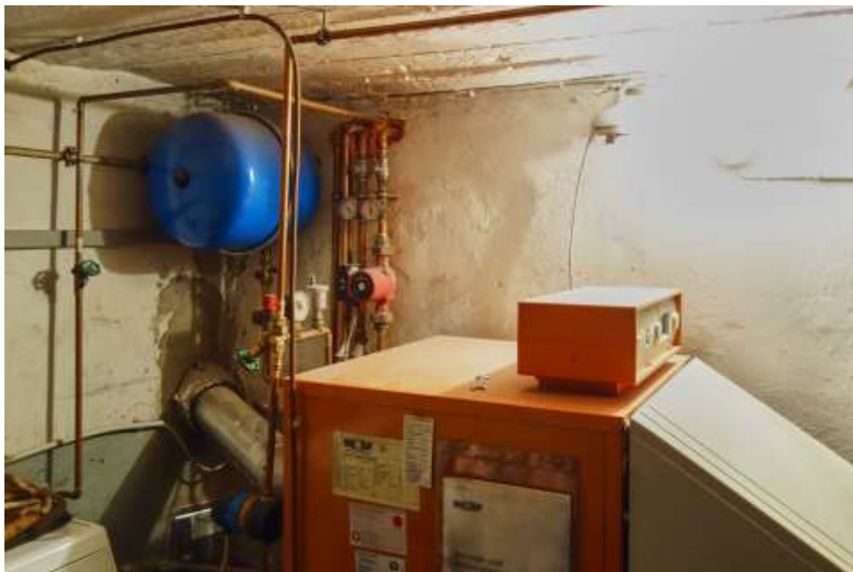
Bild 14: Ansicht Ölheizung (KG, Bj. 1996)
