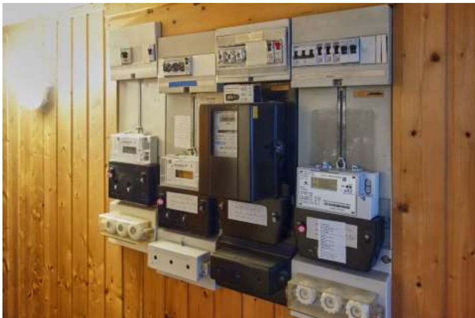
Bild 12: Ansicht Hausanschluss Elektro (KG)
