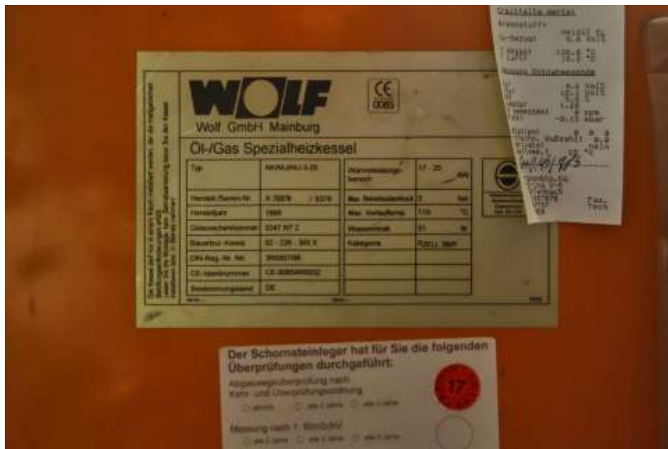
Bild 13: Ansicht Ölheizung (KG, Bj. 1996)
