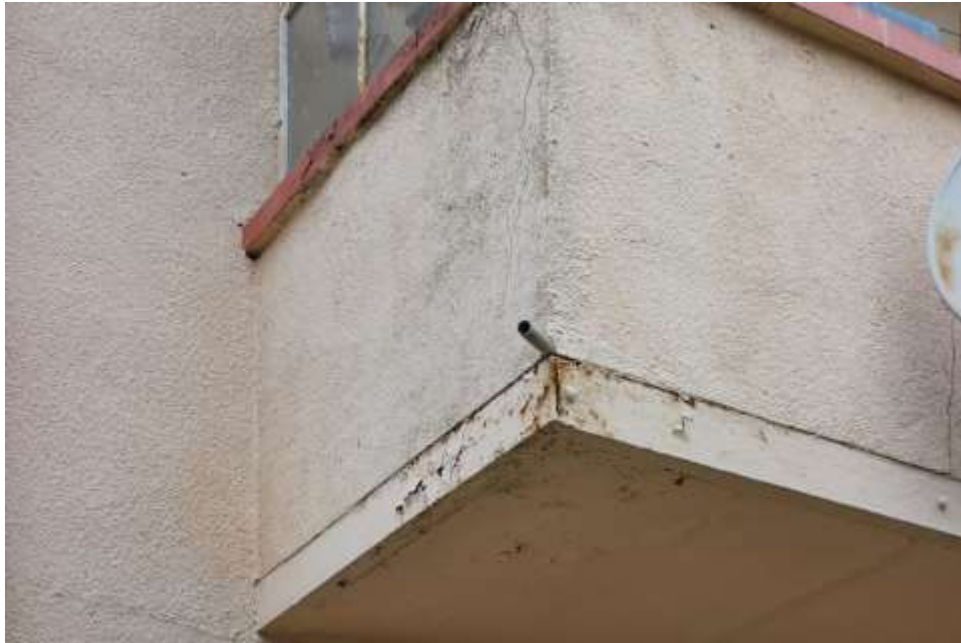
Bild 11: Ansicht Balkon (Untrhaltungsrückstau)
