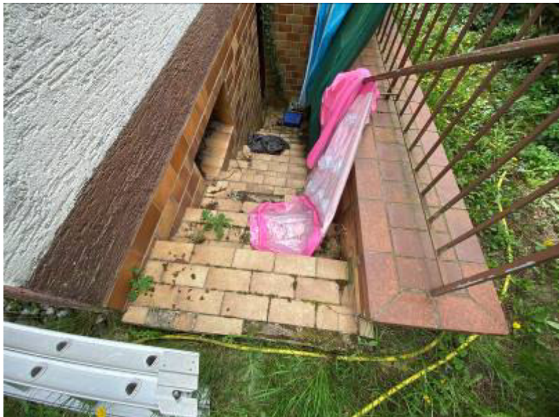
Abb. 1: Foto des SV; z.T. Fliesenbelag der Kelleraußentreppe schadhaft
