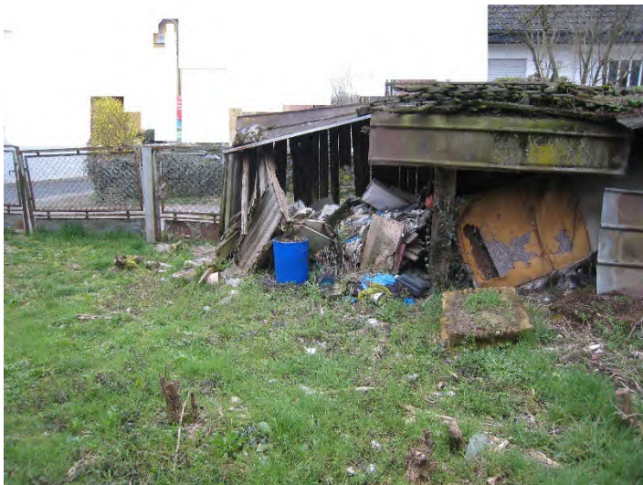
Bild Nr. 5, Gartenbereich mit teileingestürztem Nebengebäude.
