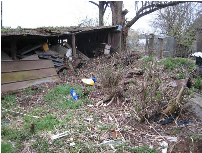
Bild Nr. 4, teileingestürztes Nebengebäude zur Nebenstraße.
