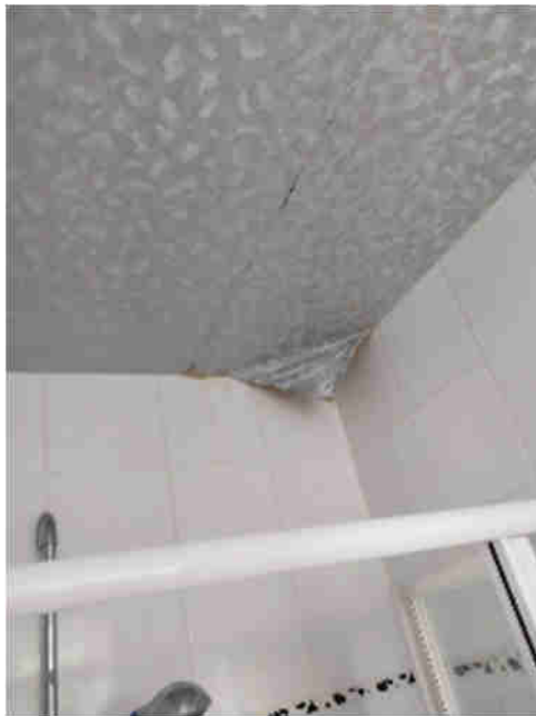
Bild 15: Feuchteschaden in der Dusche
