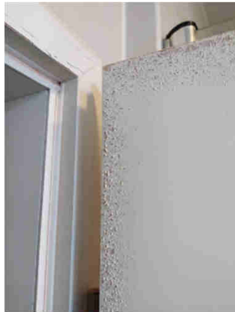
Bild 16: Feuchteschaden an der Badtüre
