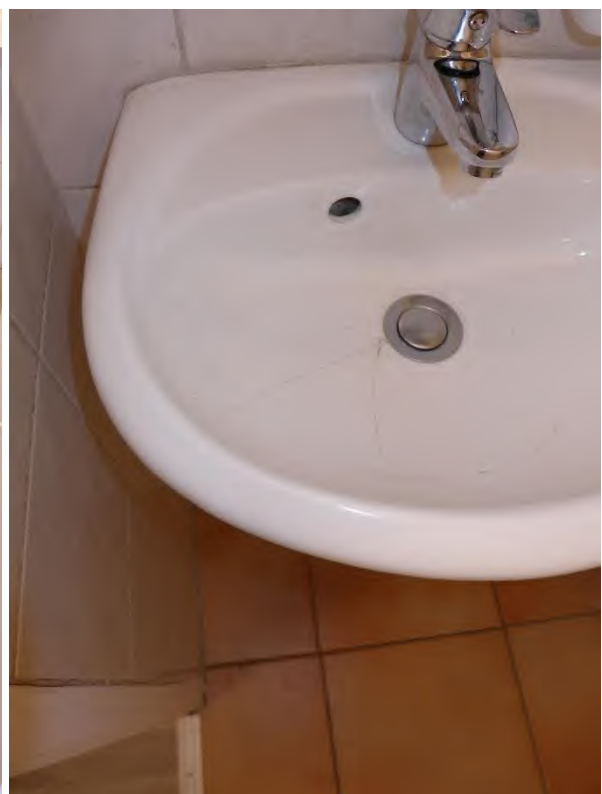
16 b beschädigtes Waschbecken
