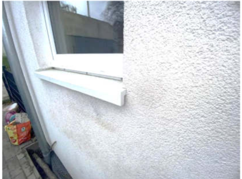
Abb. 2: Foto des SV; z.T. Fassade mit Verfärbungen
