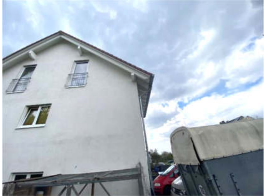
Abb. 1: Foto des SV; z.T. Fassade mit Verfärbungen
