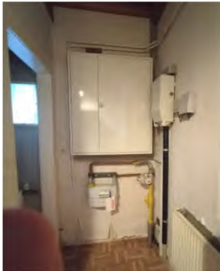
15 – Hausanschlüsse im Flur
