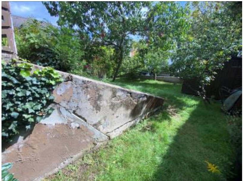
Abb. 2: Foto des SV; z.T. Stützmauer im Garten schadhaft
