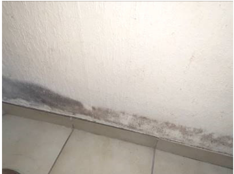
Abb. 5: Foto des SV; z.T. leichte Feuchtschäden im unteren Wandbereich des Treppenhauses
