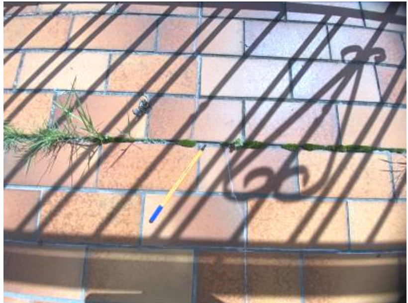
Abb. 3: Foto des SV; z.T. Balkon Fliesenbelag schadhaft (OG)
