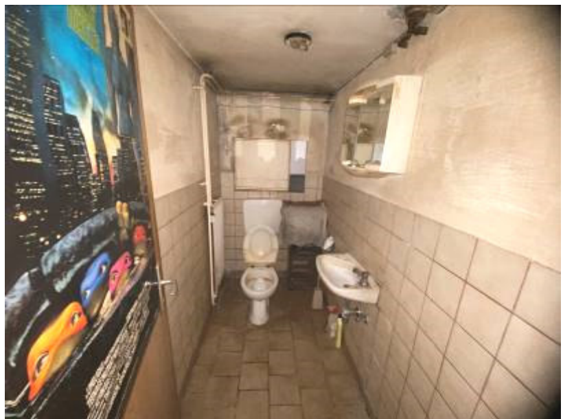
Abb. 4: Foto des SV; Sanitärobjekte (KG) überaltert
