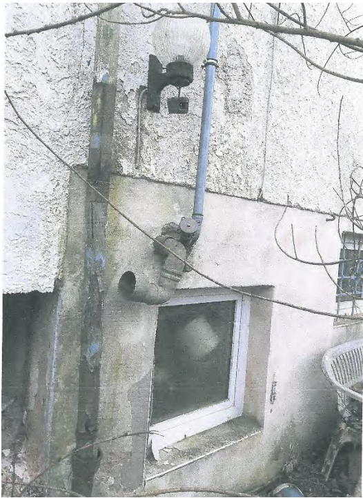
Foto Nr. 1, Außenbereich mit defekter Entwässerung.
