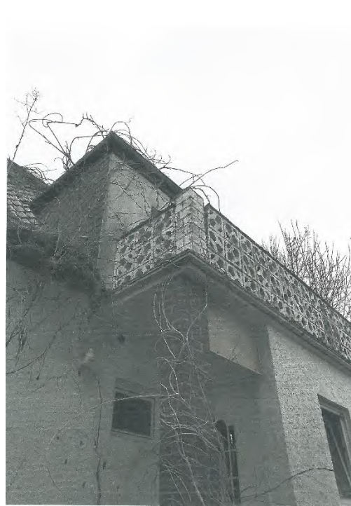
Foto Nr. 2, Balkon mit schiefer und nicht mehr standfester Brüstung. Längsriss an der Außenwand.
