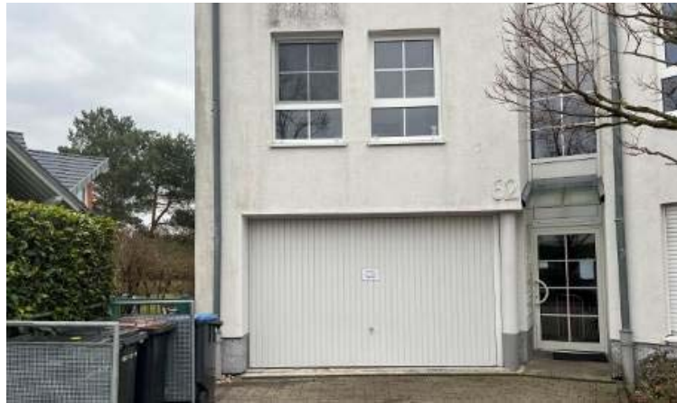
Hauseingangsbereich Nr. 62, Schmutzfahnen an Fassade
