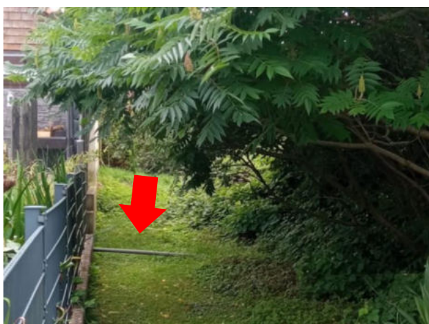
06 – Entwässerung aus Nachbargrundstück Horloffstraße 5
