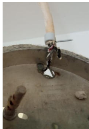
22 + 23 – Elektro Flur OG
