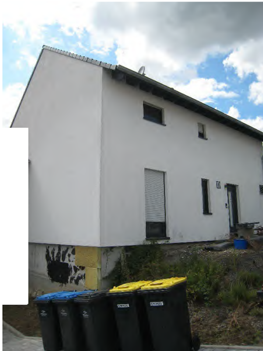
Bild Nr. 2, Ansicht zum Nachbargebäude. Sockel mit Dämmung nicht fertig gestellt.
