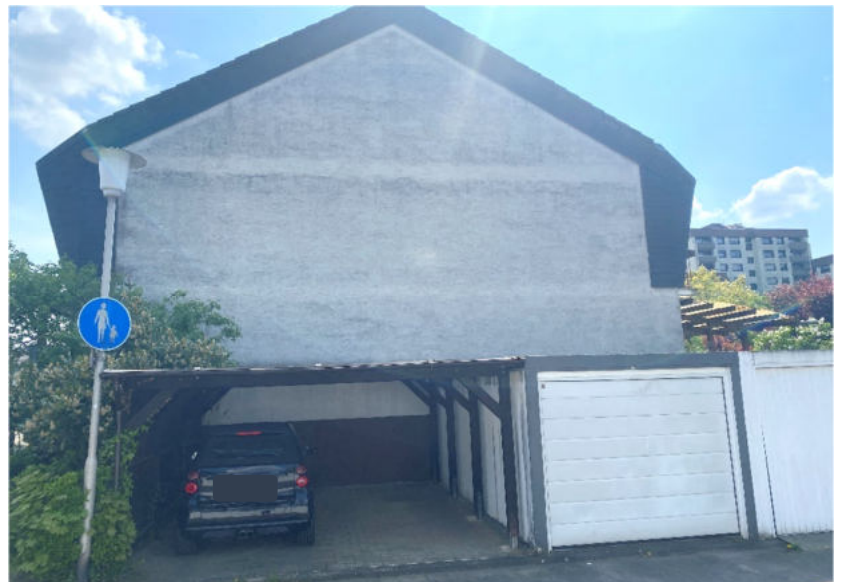
Abb. 3: Foto des SV; z.T. Putzverfärbungen Fassade; Anonymisierung d.d. SV
