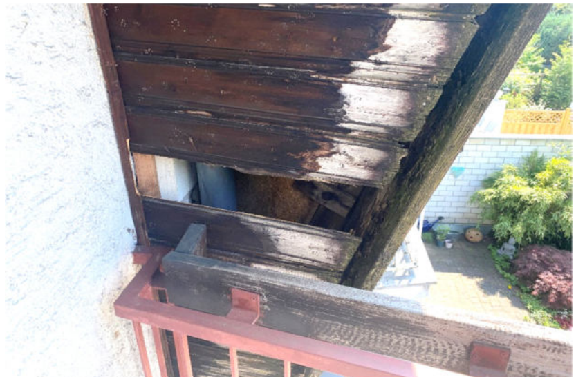
Abb. 5: Foto des SV; z.T. Holzwerk an Dachüberständen schadhaft
