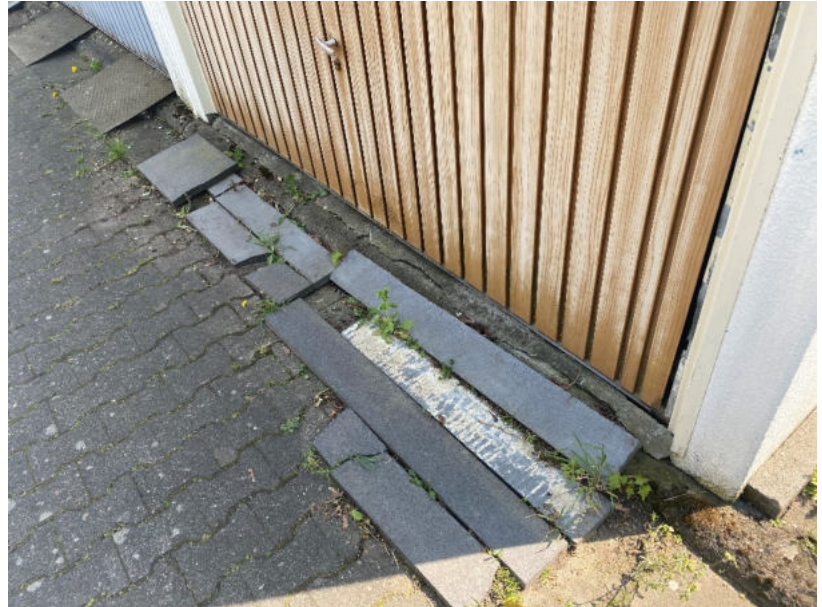
Abb. 7: Foto des SV; Absenkungen des Pflasterbelags vor der Einfahrt
