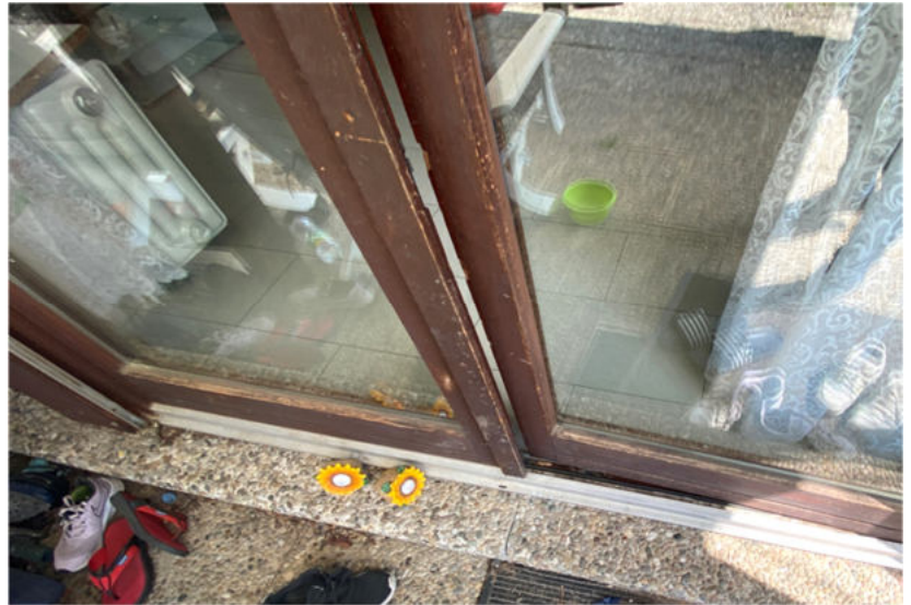
Abb. 4: Foto des SV; z.T. Fenster überholungsbedürftig
