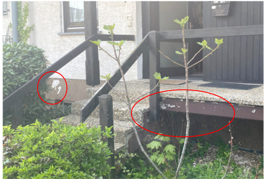
Abb. 2: Foto des SV; z.T. Fassade schadhaft
