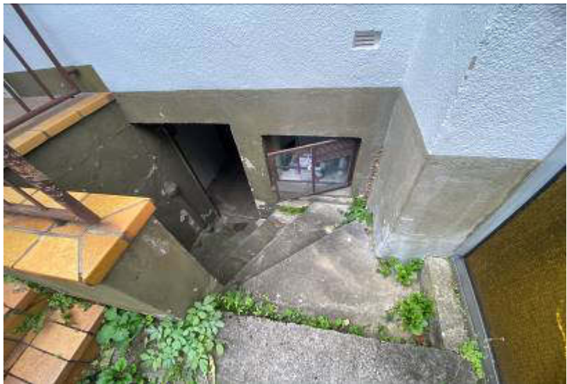
Abb. 3: Foto des SV; z.T. Sockel schadhaft, Putzschäden
