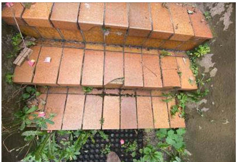
Abb. 4: Foto des SV; z.T. Fliesen d. Terrassentreppe schadhaft
