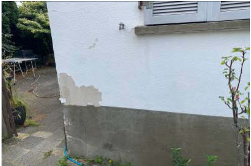
Abb. 2: Foto des SV; z.T. Sockel schadhaft, Putzschäden
