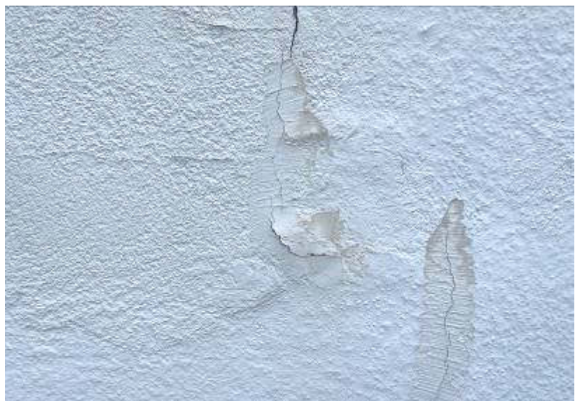
Abb. 1: Foto des SV; z.T. Fassade schadhaft, Putzrisse/Putzablösungen
