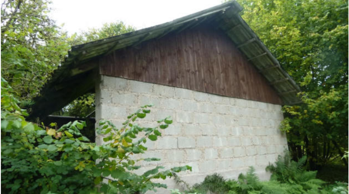
Massiver Schuppen, abgängig.
