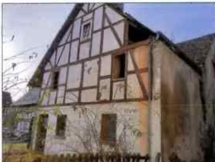
Abb. 19: ehem. Wohnhaus (Ausbau 2005), Schadstelle an Dacheindeckung und Fassade
