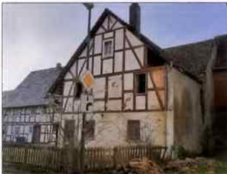
Abb. 18: ehem. Wohnhaus (Ausbau 2005), Schadstelle an Dacheindeckung und Fassade
