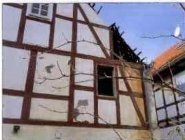
Abb. 21: ehem. Wohnhaus (Ausbau 2005), Schadstelle an Dacheindeckung und Fassade
