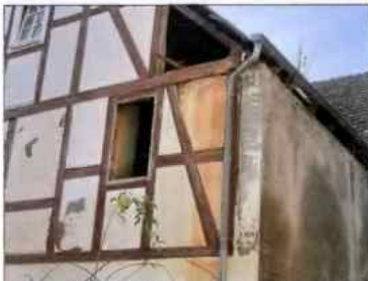
Abb. 20: ehem. Wohnhaus (Ausbau 2005), Schadstelle an Dacheindeckung und Fassade
