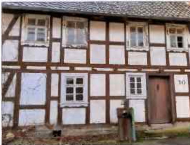
Abb. 8: Fassade mit Schadstellen an Fenstern
