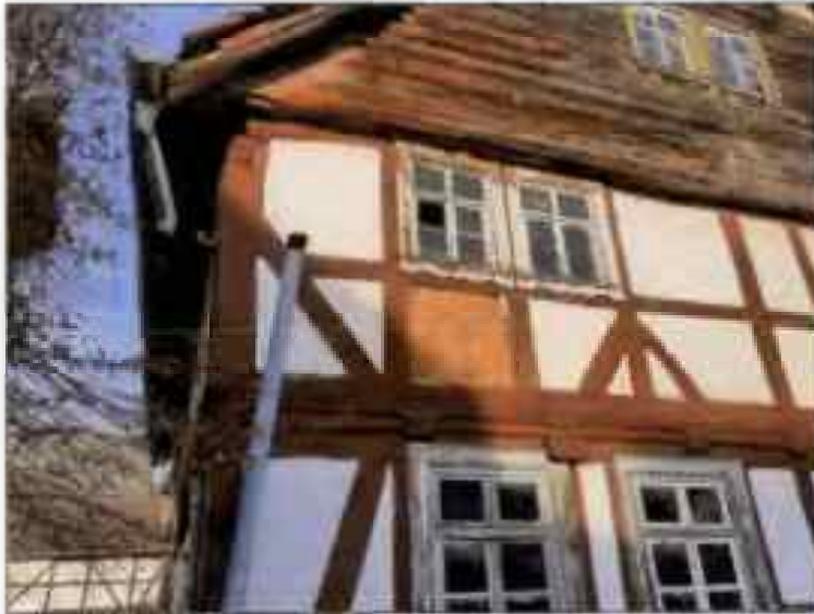
Abb. 7: Fassade mit Schadstellen
