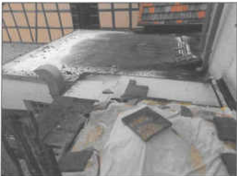
Abb. 12: Flachdach mit Undichtigkeit an Lichtkuppel
