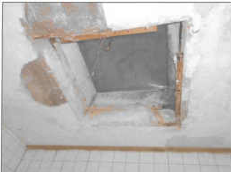
Abb. 24: Erdgeschoß, ehem. Küche, Lichtkuppel mit Wasserschaden
