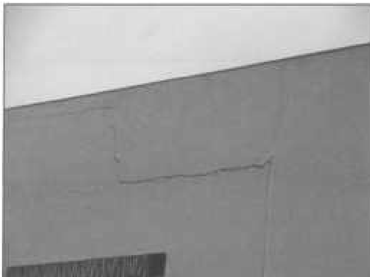
Abb. 15: Risse in Fassade (Anbau)
