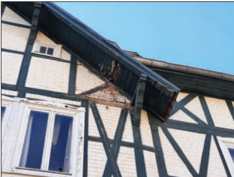
Abb. 5: Dach, Fassade - Schadstellen
