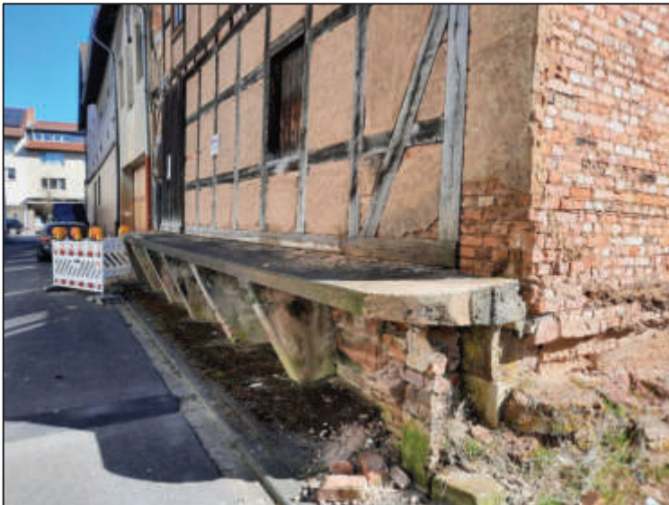
Abb. 20: Rampe und Fassade, Schadstellen
