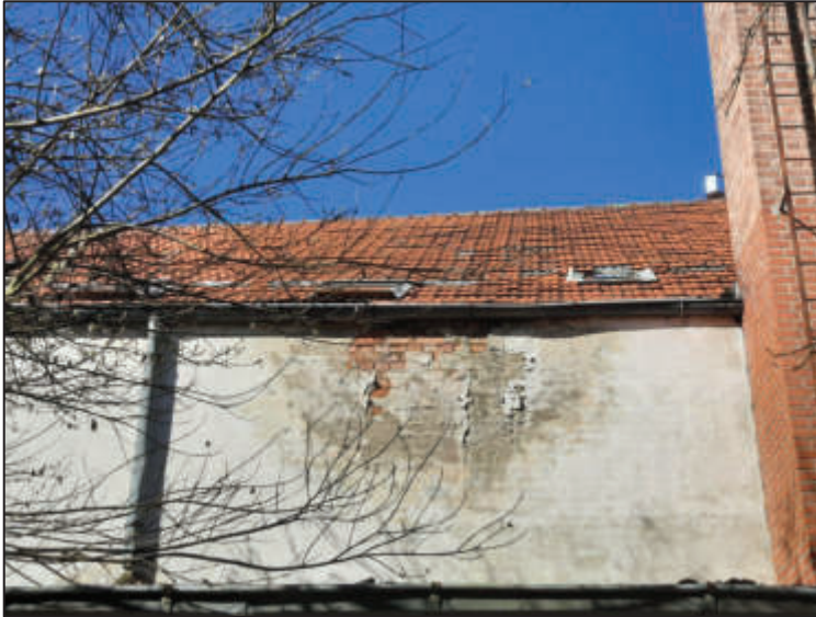
Abb. 19: Rückseite, Schadstellen - Feuchteschäden
