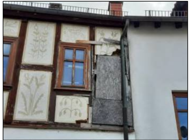
Abb. 8: Haus Nr. 1, defektes Gefach
