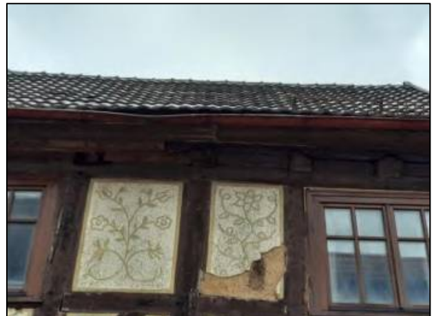
Haus Nr. 12, defektes Dachgesims und Gefache
