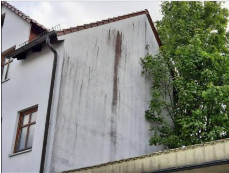
Abb. 17: Haus Nr. 3, Schadstellen Fassade
