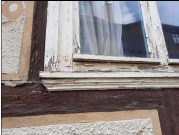
Abb. 7: Haus Nr. 1, Fensterrahmen, verwittert
