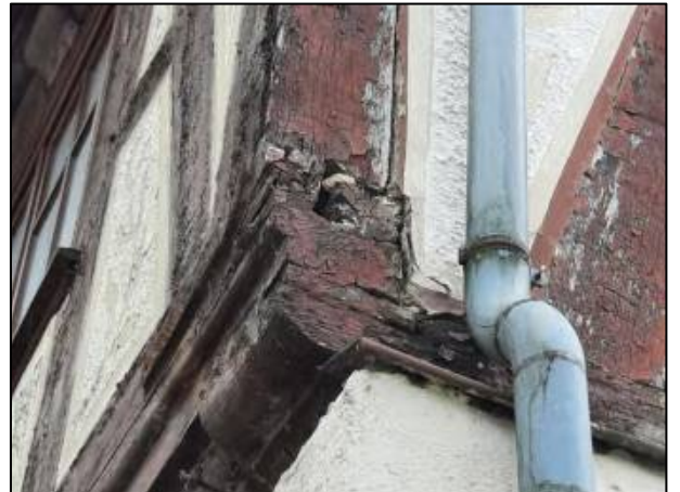
Abb. 10: Haus Nr. 1, Schadstellen an Fachwerk
