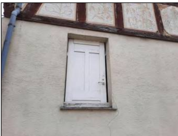
Abb. 11: Haus Nr. 1, fehlendes Fenster
