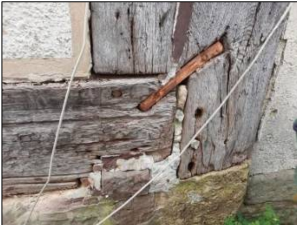
Abb. 9: Haus Nr. 1, Schadstellen an Schwelle und Pfosten
