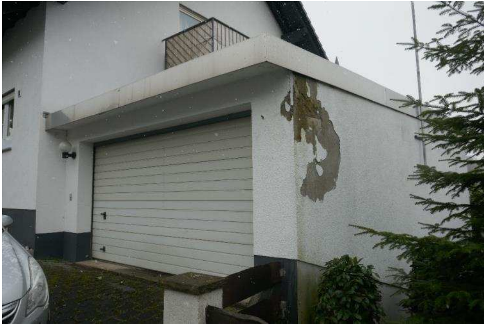
Bild 3: Doppelgarage mit Putzschäden auf der Westseite
