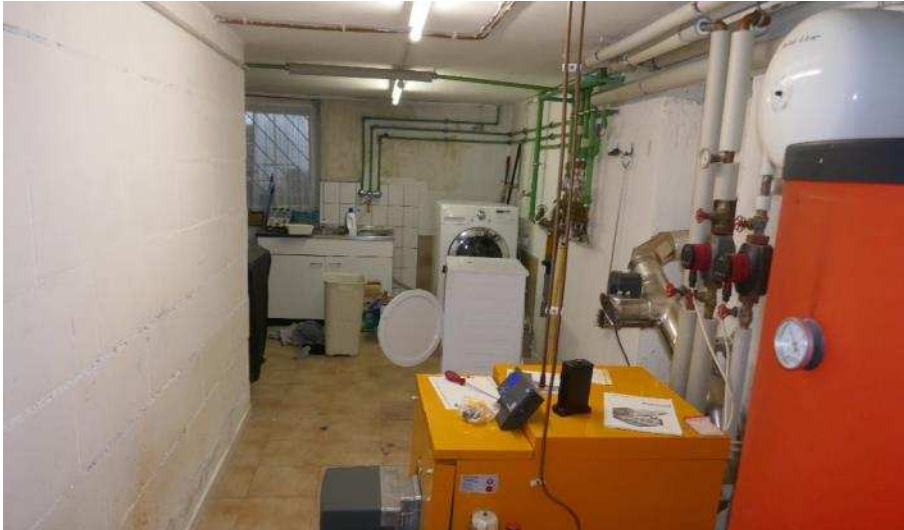
Bild 7: Hausanschlussraum im Kellergeschoss mit Heizungsanlage
