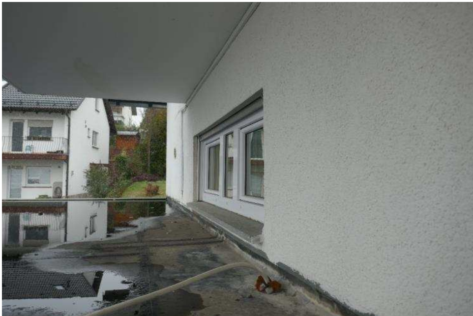
Bild 4: Wasseransammlung auf dem Flachdach der Doppelgarage
