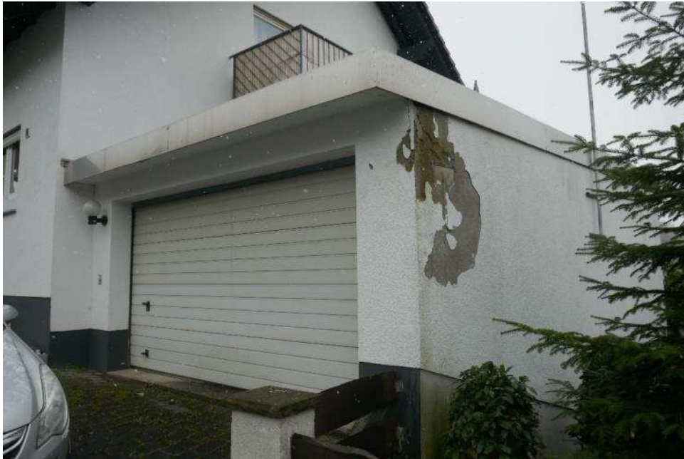
Bild 3: Doppelgarage mit Putzschäden auf der Westseite
