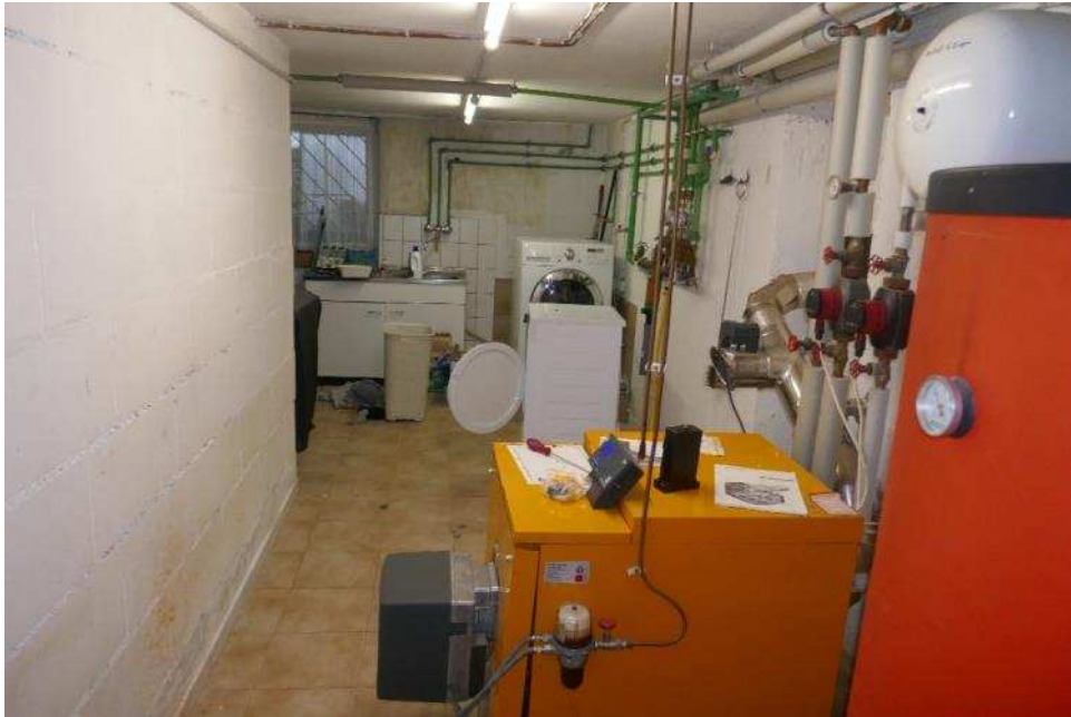
Bild 7: Hausanschlussraum im Kellergeschoss mit Heizungsanlage
