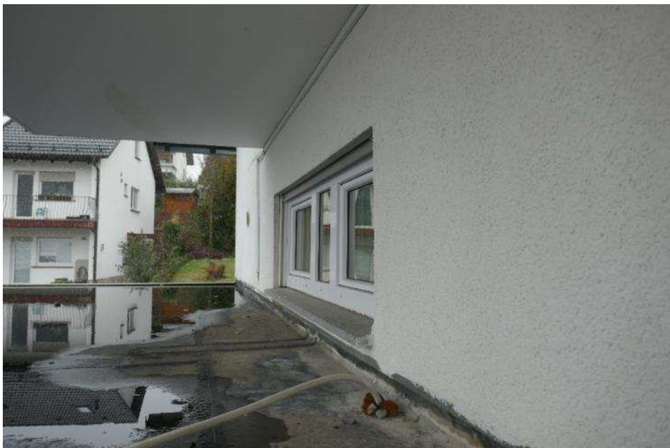
Bild 4: Wasseransammlung auf dem Flachdach der Doppelgarage
