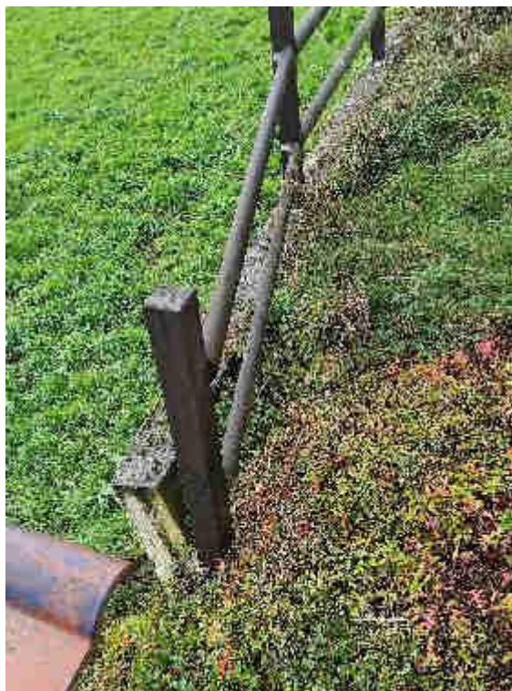
Bild 6: Schiefstand der grenzseitigen Stützmauer
