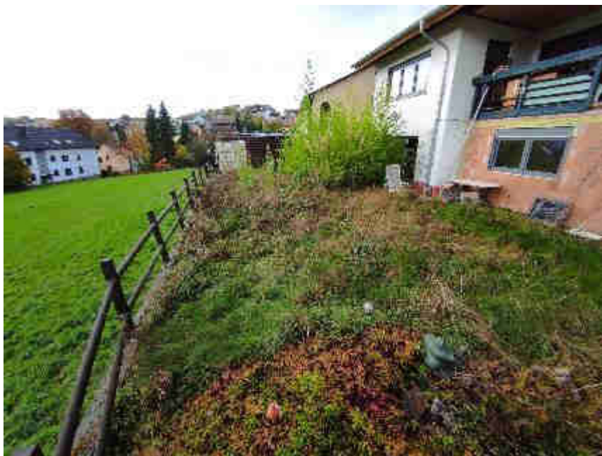
Bild 4: Gartenfläche nach Süden, schiefstehende Stützmauer zur angrenzenden Grünfläche
