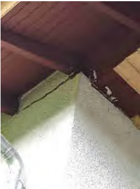
Bild 13: Fassadenriss am Dachauflager
