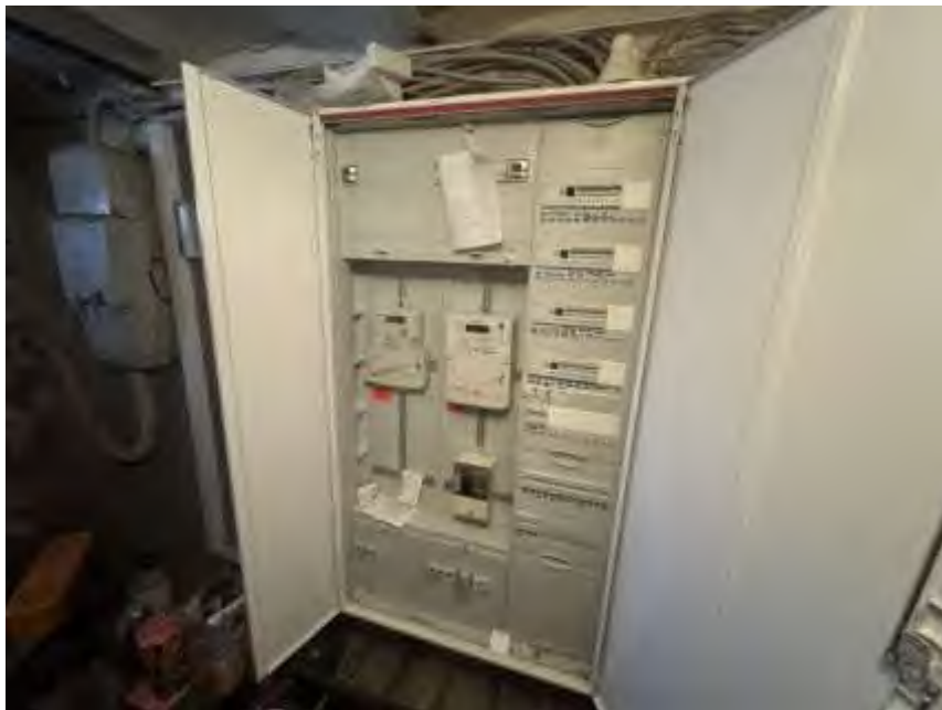
Bild 16: Zähler-/Sicherungsschrank im Kellergeschoss
