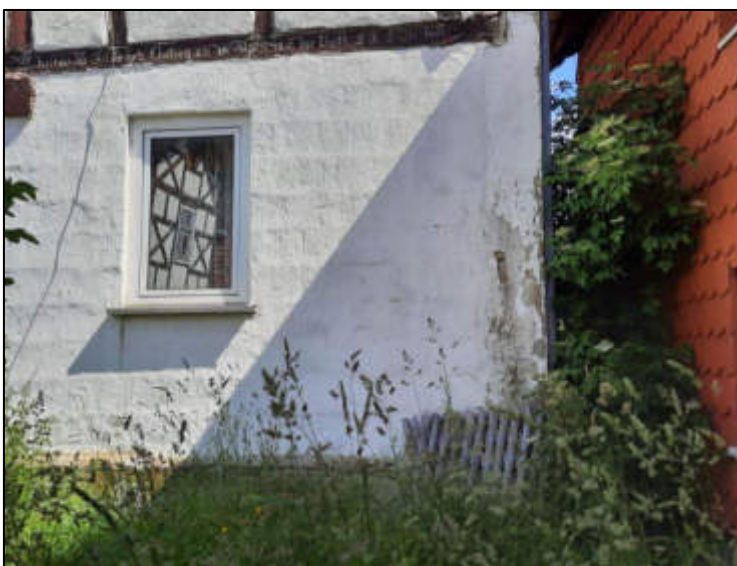
Abb. 15: Schadstellen an Fassade Wohnhaus Giebelseite
