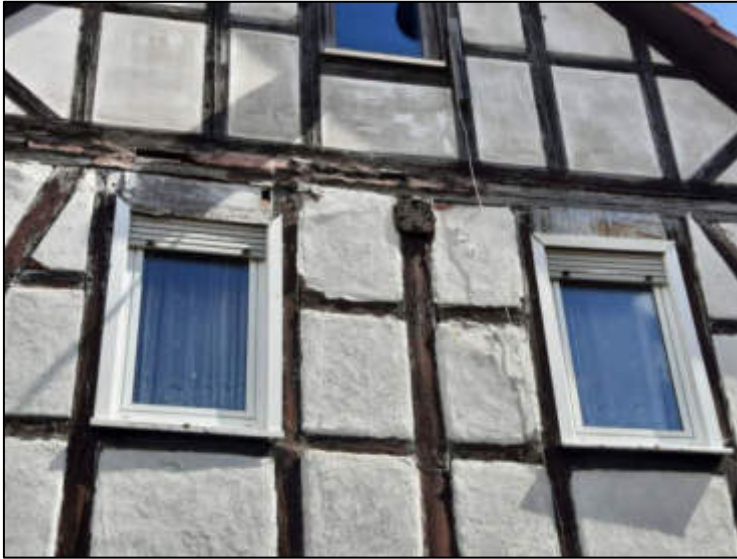
Abb. 13: Schadstellen an Fassade Wohnhaus Giebelseite
