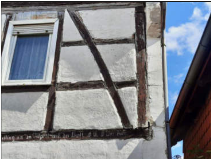
Abb. 14: Schadstellen an Fassade Wohnhaus Giebelseite
