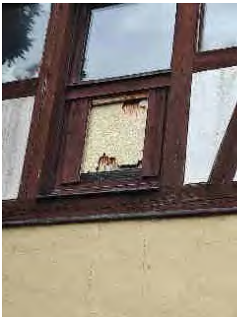
Bild 15: Instandsetzungsbedarf am Fachwerkgiebel (4)
