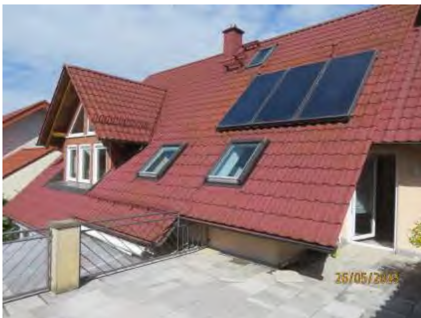
Bild 8: Teilrückansicht mit der solarunterstützten Brauchwassererwärmungsanlage
