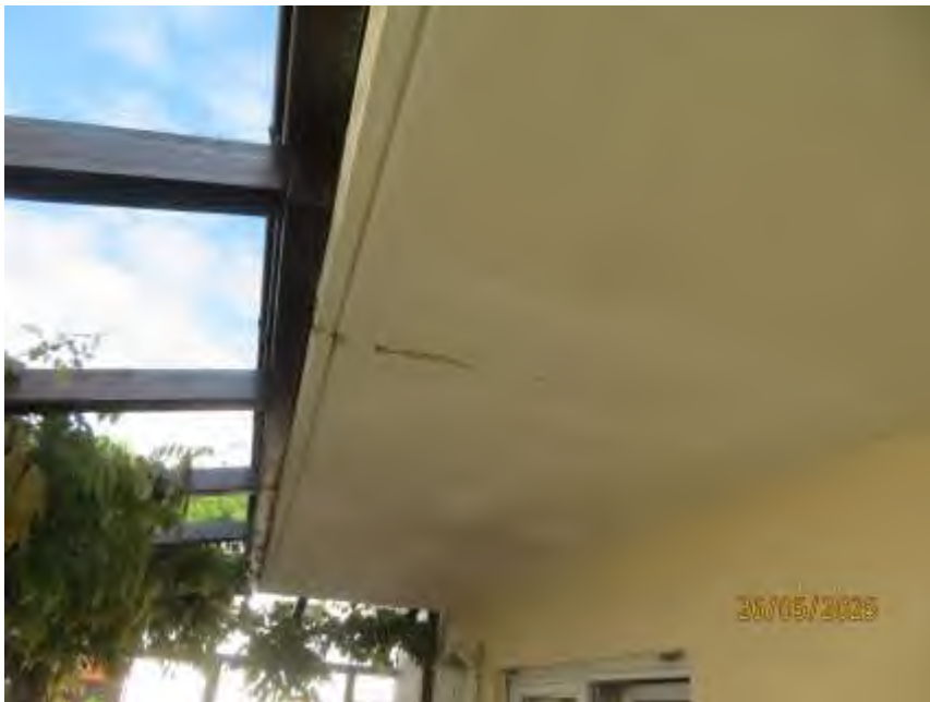
Bild 12: Teilansicht zu dem seitlichen Balkon mit Feuchteschäden
