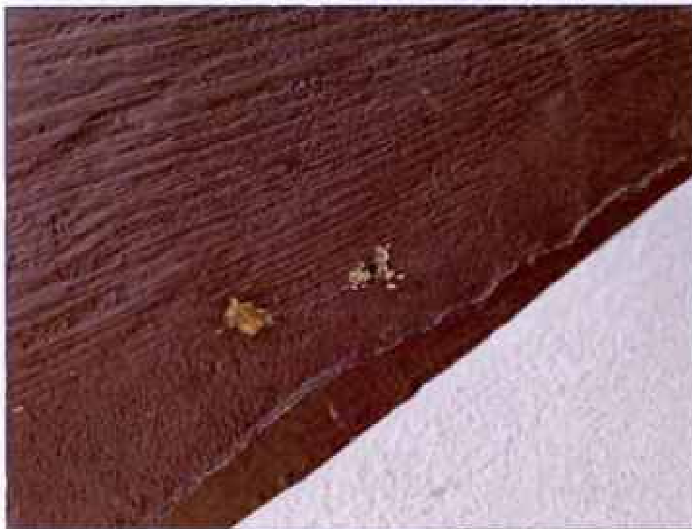
Holzwurmlöcher im Fachwerk
