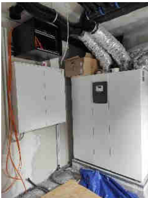
Bild 13: Hausanschlussraum m. Wärmepumpe
