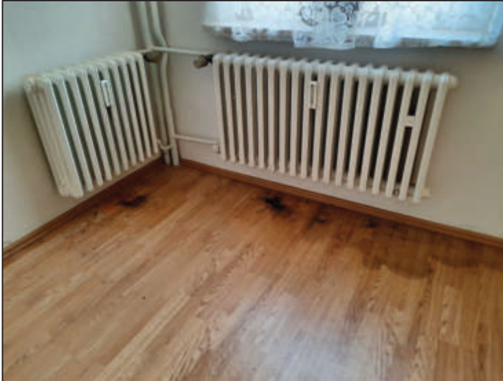
Abb. 19: Feuchteschäden auf Boden unter Heizkörper
