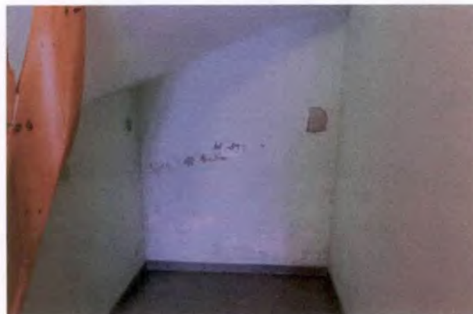
Bild 6: EG - Feuchteschäden Treppenhaus
