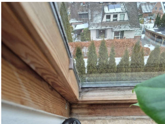
Dachflächenfenster mit Feuchtigkeit im Holzrahmen
