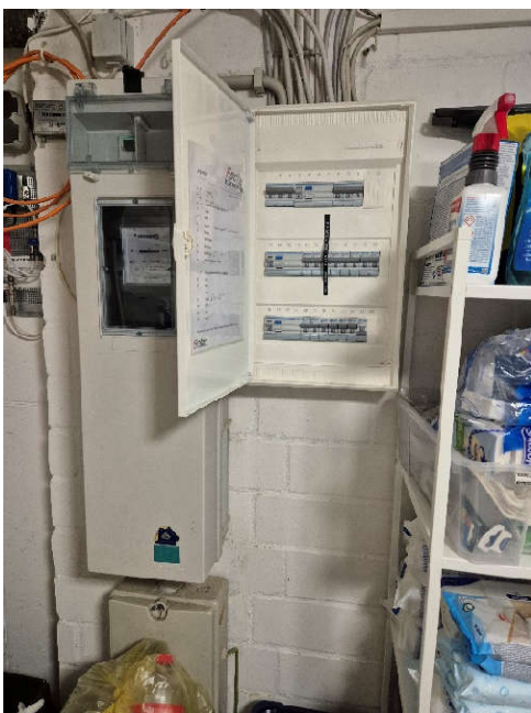
Sicherungskasten und Stromzähler
