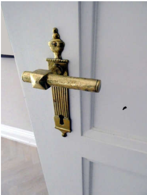
Bild 45: EG Original-Beschläge Türen
