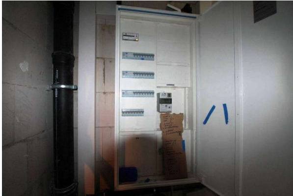
Sicherungsverteilung im Lager
