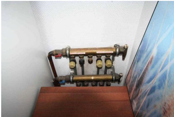
Anschlüsse für die Fußbodenheizung und Flur des DG
