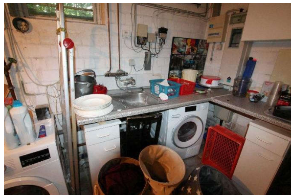
und Waschmaschine, Trockner, Sicherungskasten und Stromzähler
