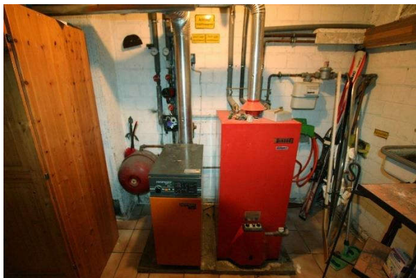
Heizungskeller mit Heizung
