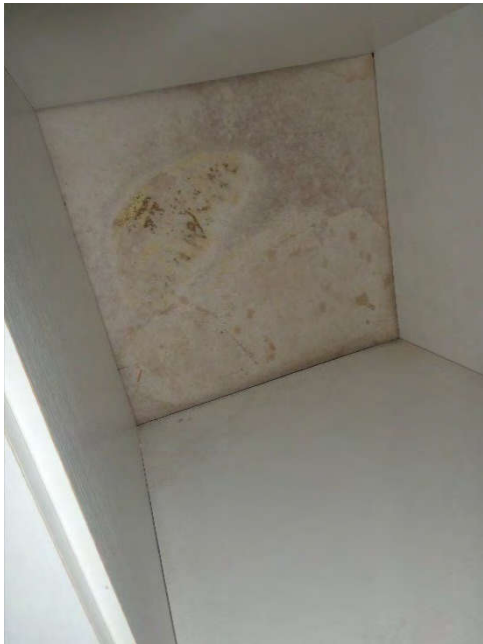
Bild 69: KG Kellerraum Schimmelpilzbefall Mobilar
