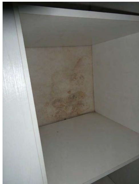
Bild 68: KG Kellerraum Schimmelpilzbefall Mobilar
