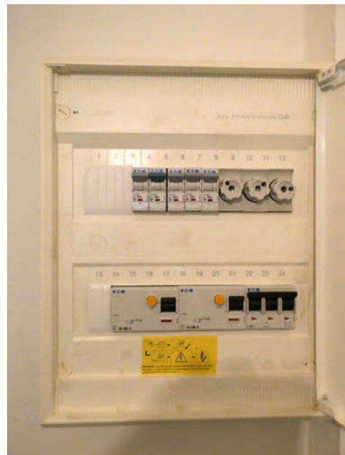
Bild 16: Whg. Nr. 14 Flur / Elektrik
