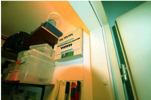
Sicherungsverteilung in der Abstellkammer
